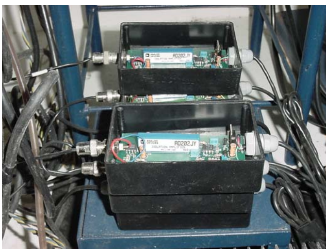
Figura 4.5 - Amplificadores – transmissores de sinais.
