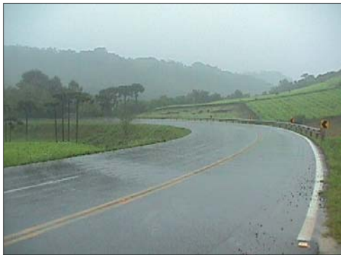
Foto 13 - km 104 - Trecho em curva acentuada, proteção através de defensas. Terceira faixa na pista da esquerda.
