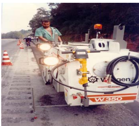
Figura 21 - Detalhe da Execução de Guia Sonora no Acostamento. Fonte: (Arquivo da Empresa Paulifresa)
