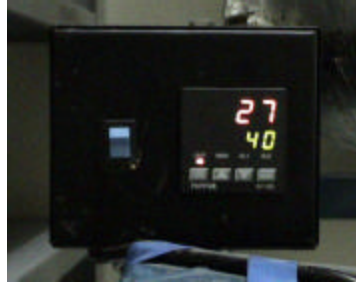
Figura 3.23 – Controlador de temperatura ajustado para 40°C.
