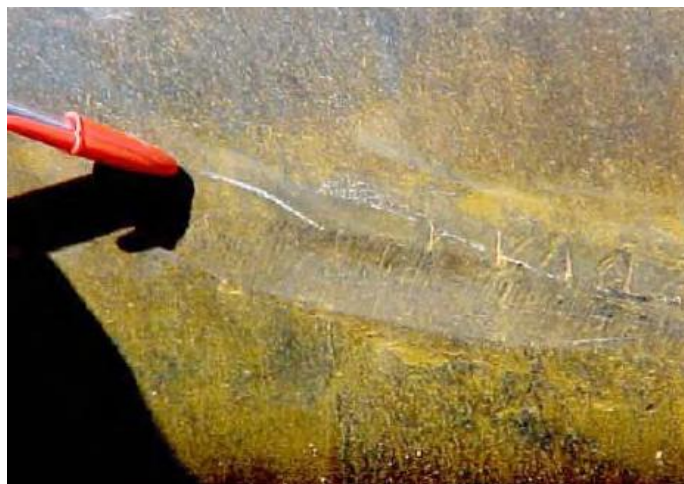
Figura 11 – Dano no duto por puncionamento
