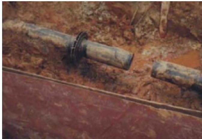
Figura 9 – Ruptura de tubulação por tração
