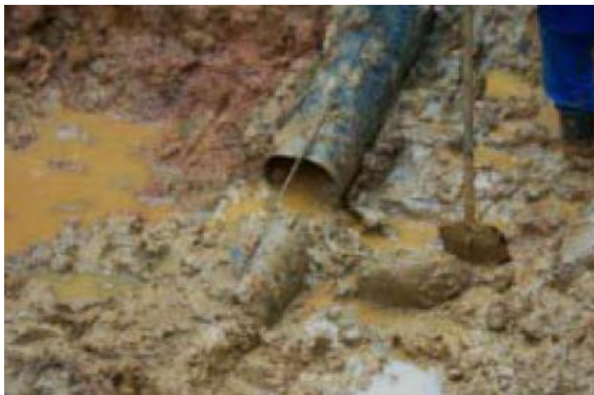
Figura 13 – Ruptura por tração no duto OLAPA
