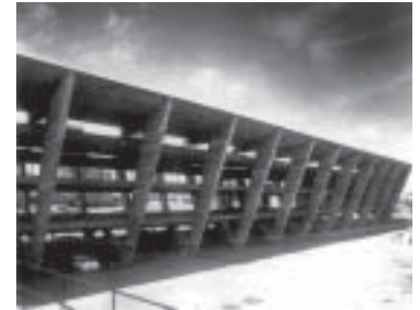
34 Museu de Arte Moderna. Vista do pavilhão de exposições durante as obras. Reidy. Rio de Janeiro, 1953
