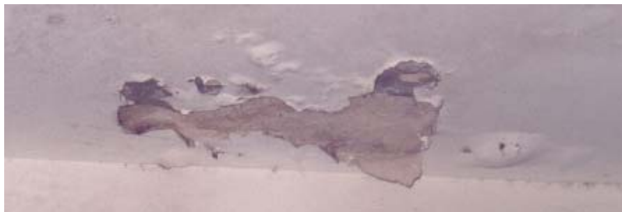
Figura 15: manifestação patológica de impermeabilização causando destruição da pintura.
