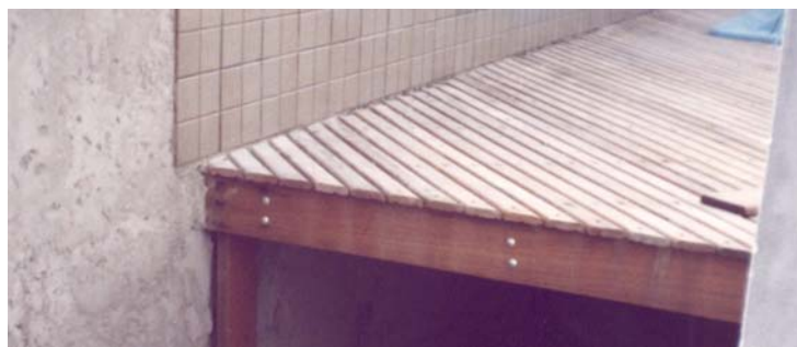
Figura 69: deque de piscina ocasionando manifestação patológica.
