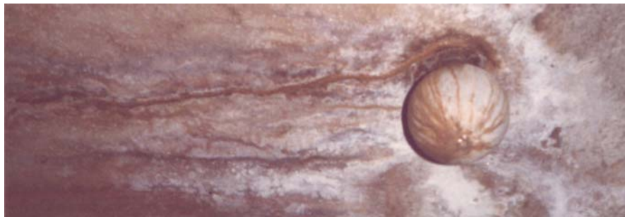
Figura 5: infiltração de água por conduíte elétrico
