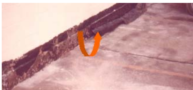
Figura 57: manifestação patológica por deslocamento da impermeabilização.
