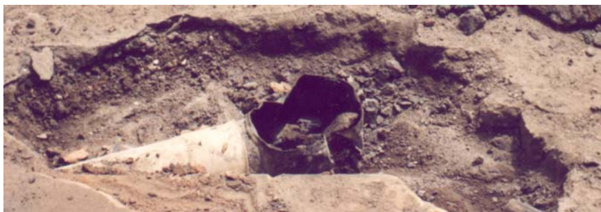
Figura 6: manifestação patológica em coletor pluvial sobre a impermeabilização
