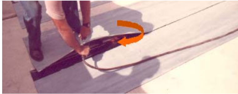
Figura 46: solda com maçarico a gás pode agredir a manta asfáltica.
