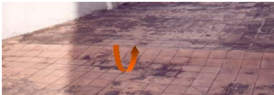
Figura 65: Movimentação do piso de acabamento ocasionando manifestação patológica.
