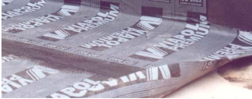
Figura 18: manta asfáltica não aderida.
