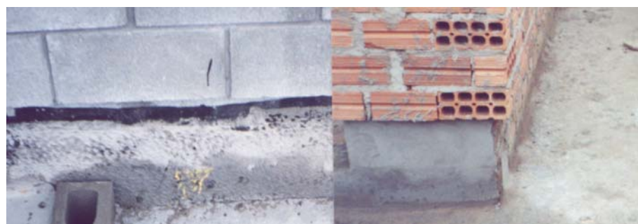
Figura 63: platibanda com bloco de concreto/tijolo furado, passível de manifestação patológica.
