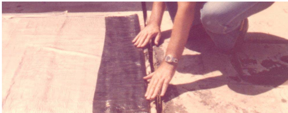
Figura 10: junta de dilatação em laje de cobertura.
