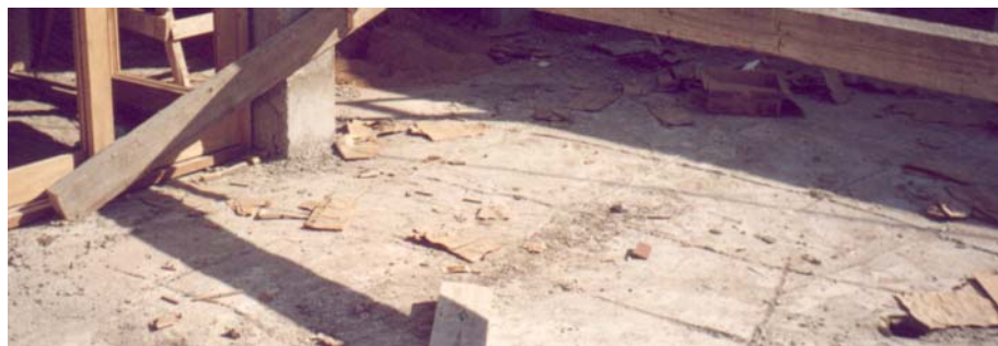
Figura 54: danos à impermeabilização durante execução da obra
