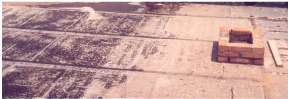
Figura 39: manifestação patológica por falta de execução de piso final.
