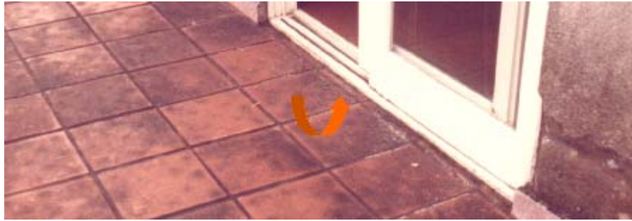
Figura 9: falta de desnível entre níveis interno e externo
