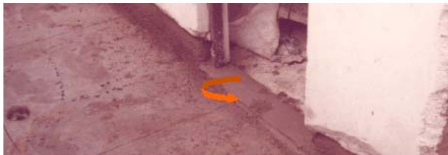
Figura 64: surgimento de manifestação patológica devido a falta de desnível.
