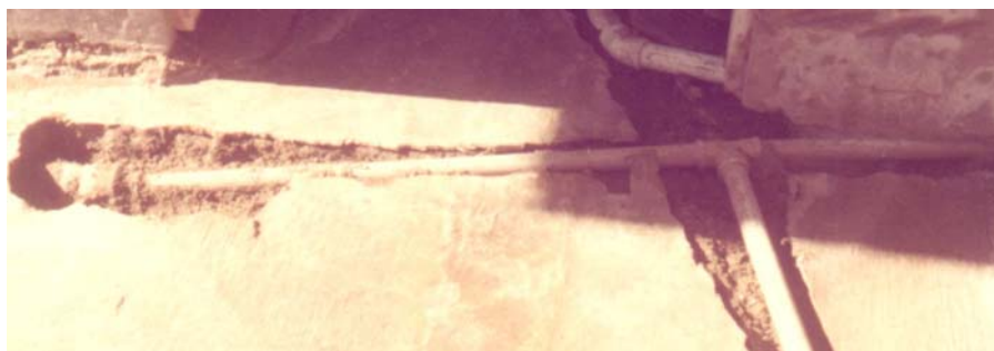
Figura 59: manifestação patológica por tubulação embutida em enchimento na laje.
