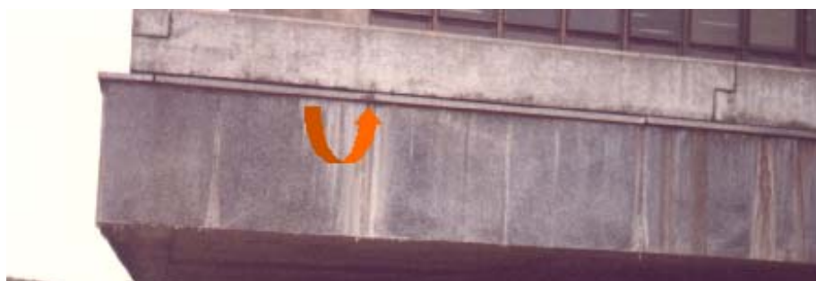
Figura 62: manifestação patológica por falta de aplicação de material vedante.
