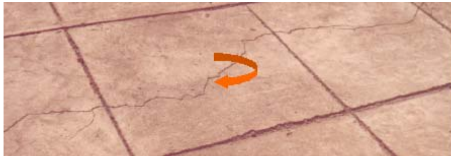
Figura 40: fissura em piso cimentado proveniente da falta de mastique entre as juntas.
