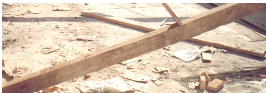
Figura 67: manifestação patológica por descuido do pessoal da obra.
