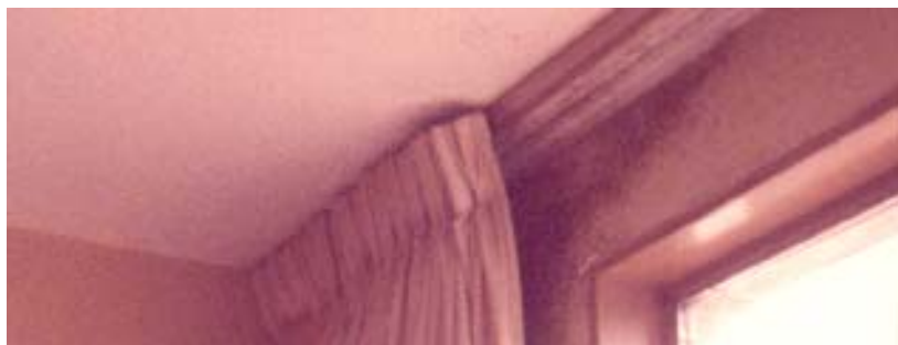
Figura 12: manifestação patológica de impermeabilização originando mofo.
