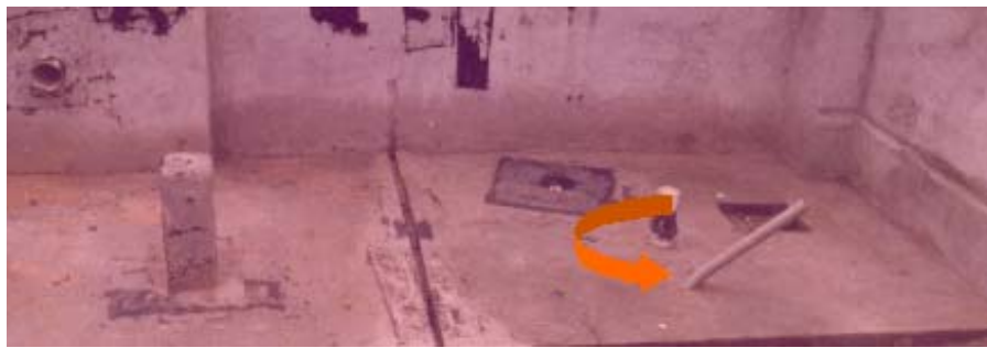
Figura 44: execução de peças emergentes agredindo impermeabilização existente.
