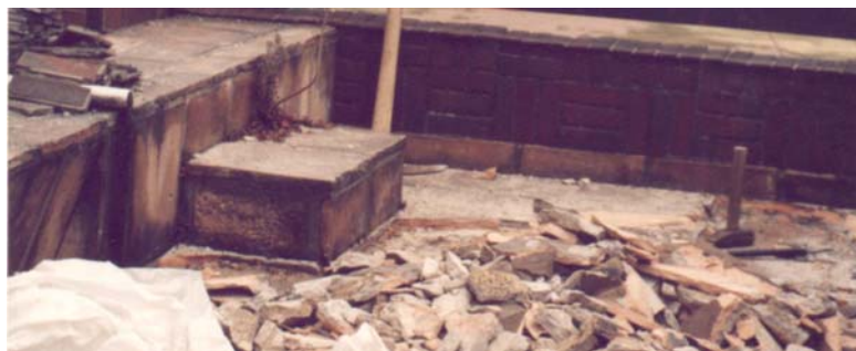
Figura 45: são comuns os ferimentos na impermeabilização quando da troca de piso.
