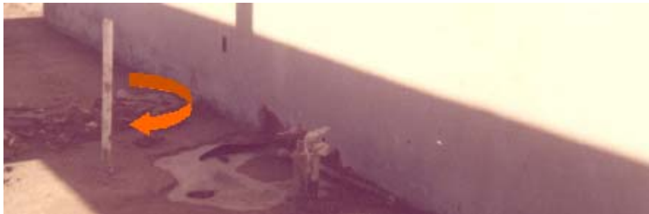
Figura 8: manifestação patológica pela falta de proteção em tubulações que aflorem da laje
