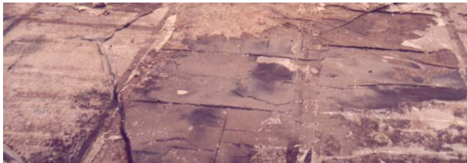
Figura 38: manifestação patológica resultante da falta de proteção adequada da manta asfáltica.
