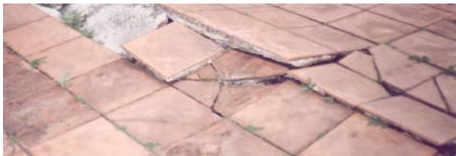
Figura 41: manifestação patológica decorrente da falta de previsão de juntas de dilatação.
