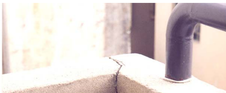
Figura 60: manifestação patológica por movimentação térmica e/ou estrutural.
