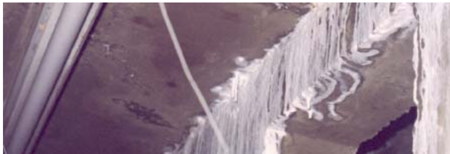
Figura 13: eflorescência dando origem às estalactites.
