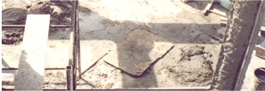
Figura 43: excessiva colocação de entulho e equipamentos sobre a impermeabilização.
