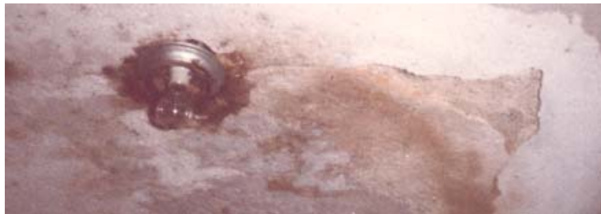
Figura 14: manifestação patológica causando deterioração dos materiais.
