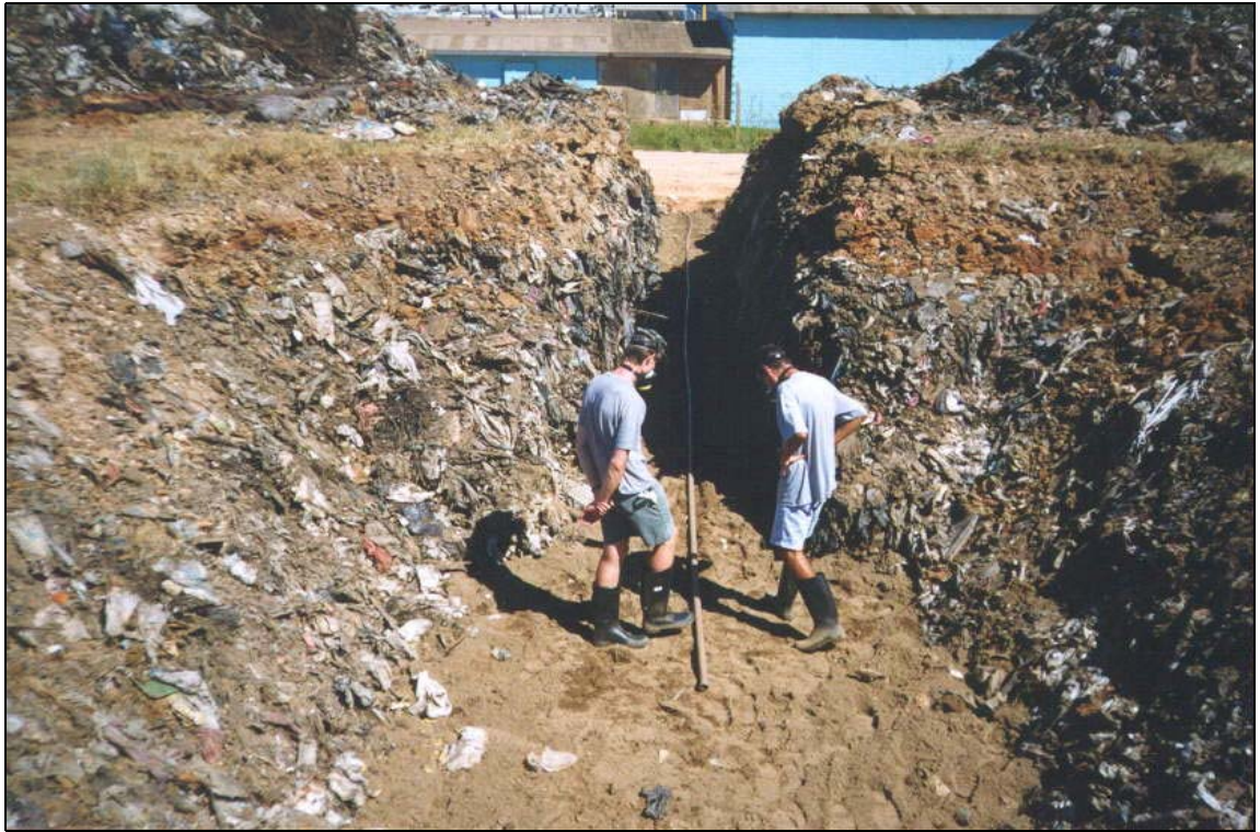
Figura C5 – Detalhe do dreno de lixiviado da célula C6.
