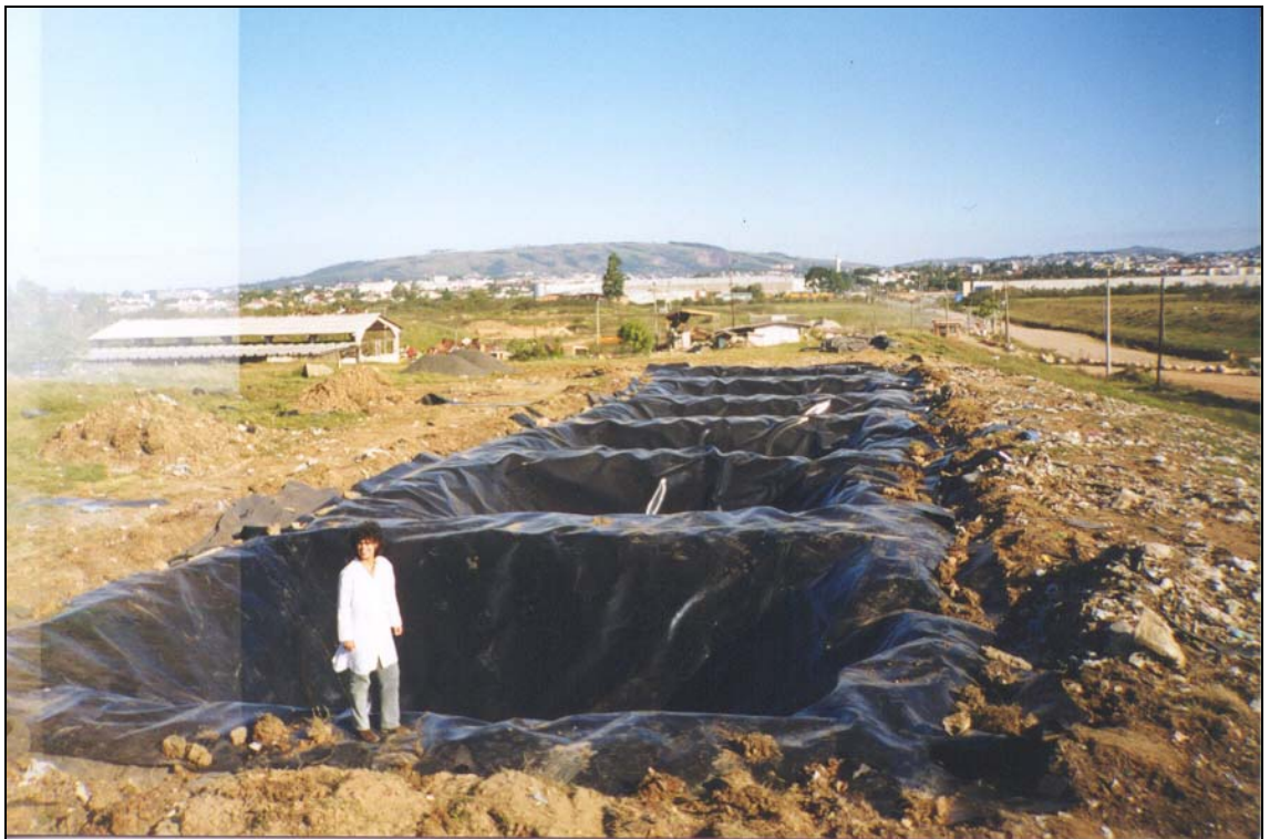
Figura C13 – Vista do conjunto das células recobertas por PEAD. À direita, o talude sob o qual estão as valas já preenchidas com resíduo.
