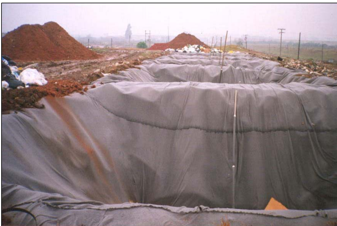
Figura C15 – Drenos de gás, envoltos por BIDIM 400, dispostos no conjunto das células, precedendo a colocação dos resíduos.
