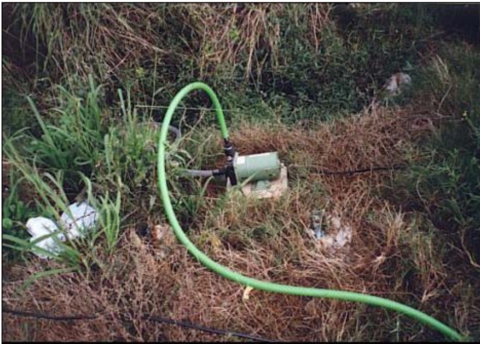
Figura C38 – Bomba utilizada para recalcar o lixiviado recolhido na saída do dreno de lixiviado para a base superior das células.
