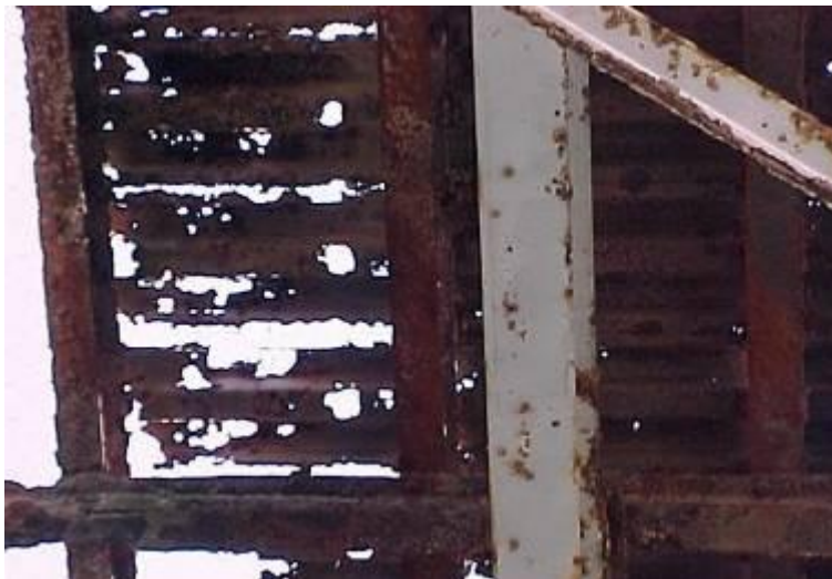
Figura 5 – Exemplo de corrosão generalizada em um tubo de aço carbono ( http://clanes.blogspot.com/ ).
