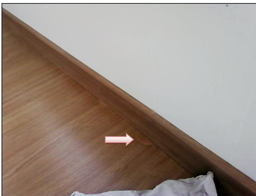
Figura 27: detalhe da água no piso decorrente da infiltração
