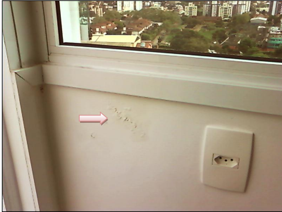
Figura 29: formação de bolhas abaixo da janela devido à infiltração
