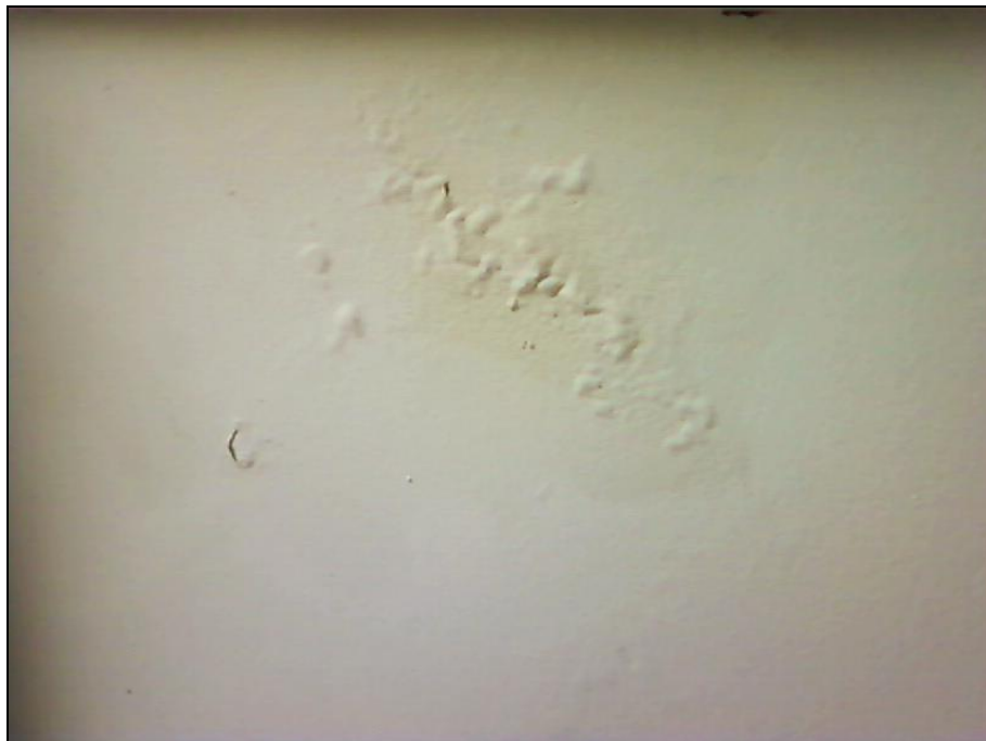
Figura 30: detalhe da formação de bolhas abaixo da janela
