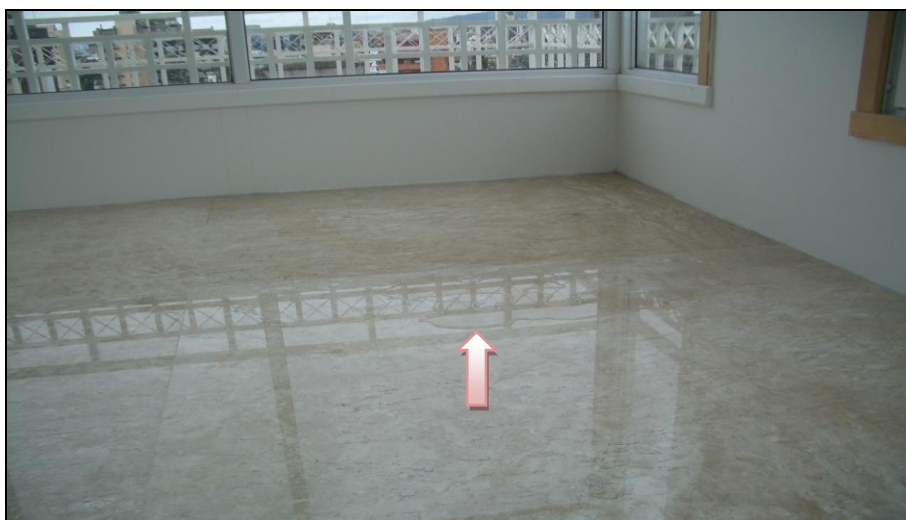
Figura 20: detalhe da água no piso junto à janela 16
