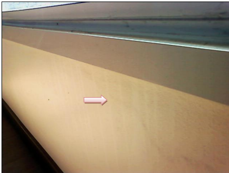
Figura 28: detalhe da marca na parede devido ao escoamento d'água
