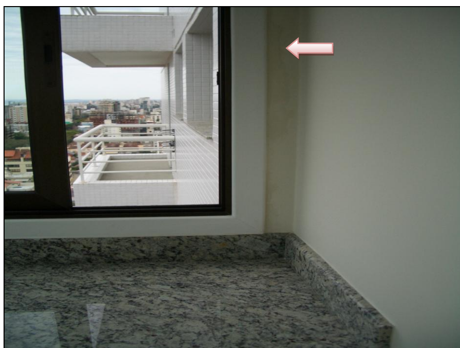
Figura 18: infiltração verificada na parede ao lado da guarnição 14
