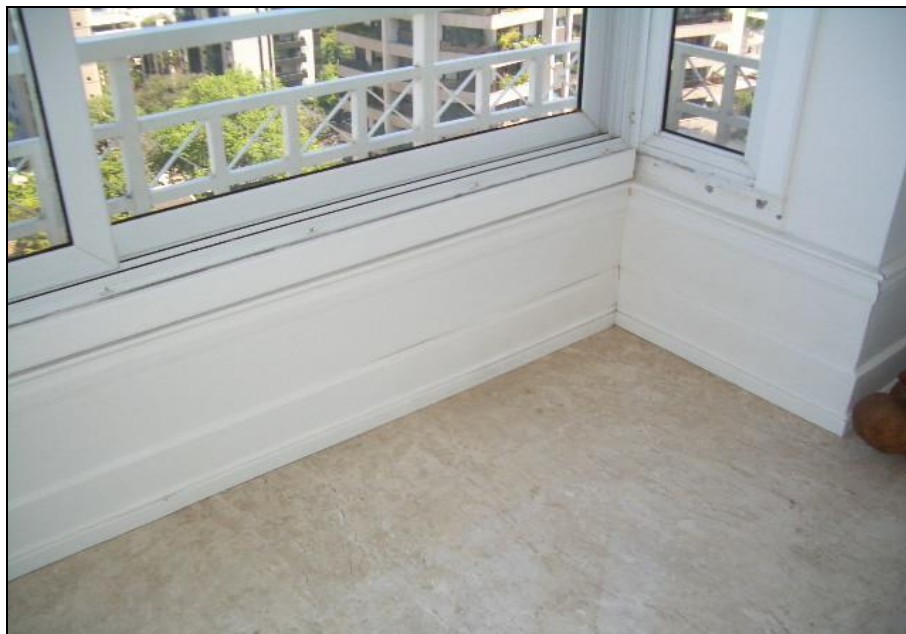
Figura 19: infiltração verificada na parede abaixo da janela 15
