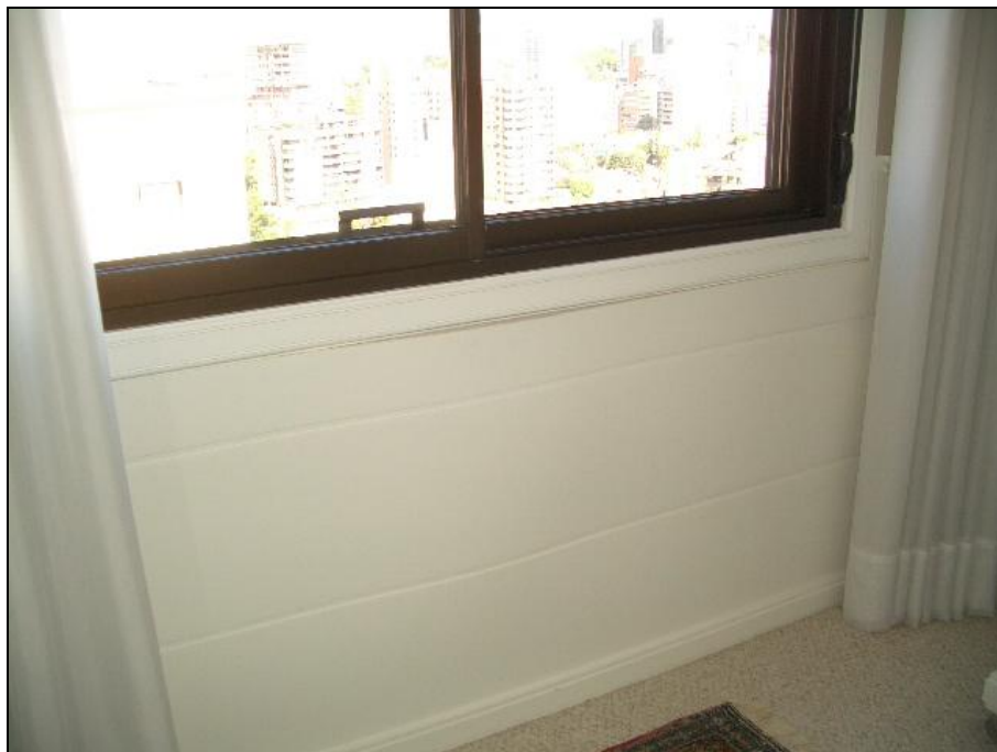
Figura 23: infiltração em janela do 17º pavimento 19
