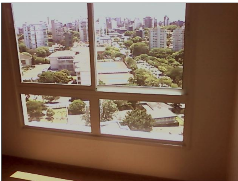
Figura 26: janela de correr de alumínio com infiltração
