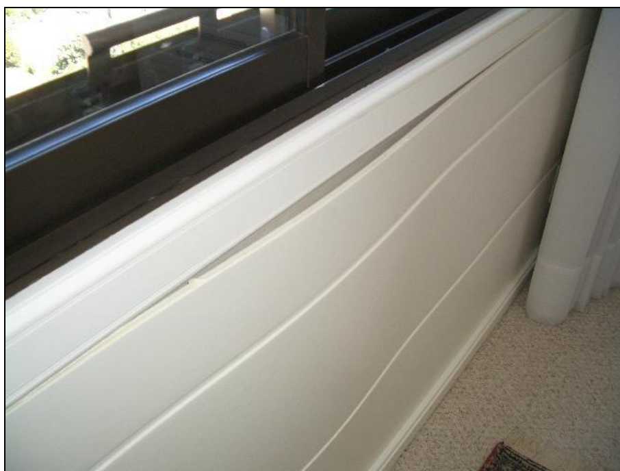
Figura 24: detalhe do painel de madeira empenado devido à infiltração 20
