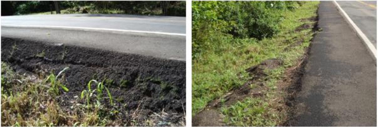
Figura 14: medidas amenizadoras dos efeitos na rodovia: à esquerda, adição de sucessivas camadas de concreto asfáltico e à direita, deslocamento da pista
