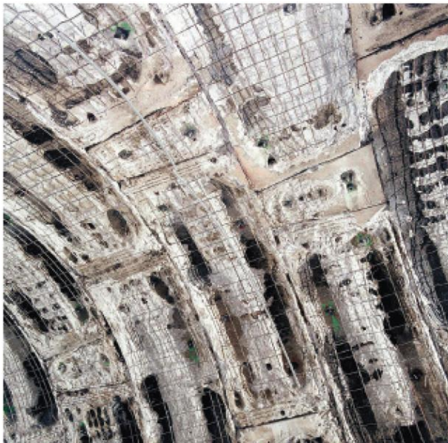
Figura 3: danos por fogo no revestimento de concreto do Channel Tunnel (MEHTA; MONTEIRO, 2008, p. 154) 3
