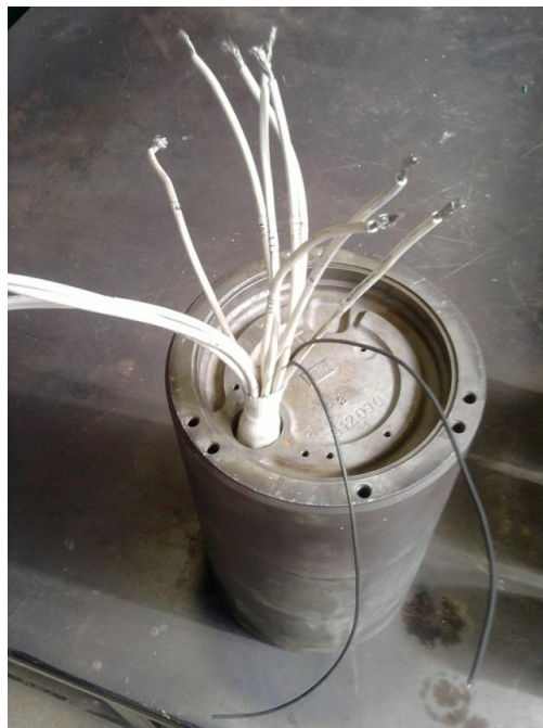
Figura 31 Carcaça e terminais de ligação do motor elétrico rebobinado.
