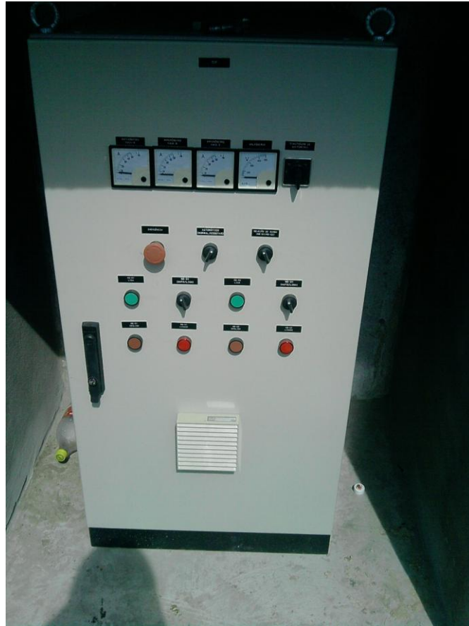
Figura 38 Quadro elétrico de motobomba submersível padrão CORSAN.
