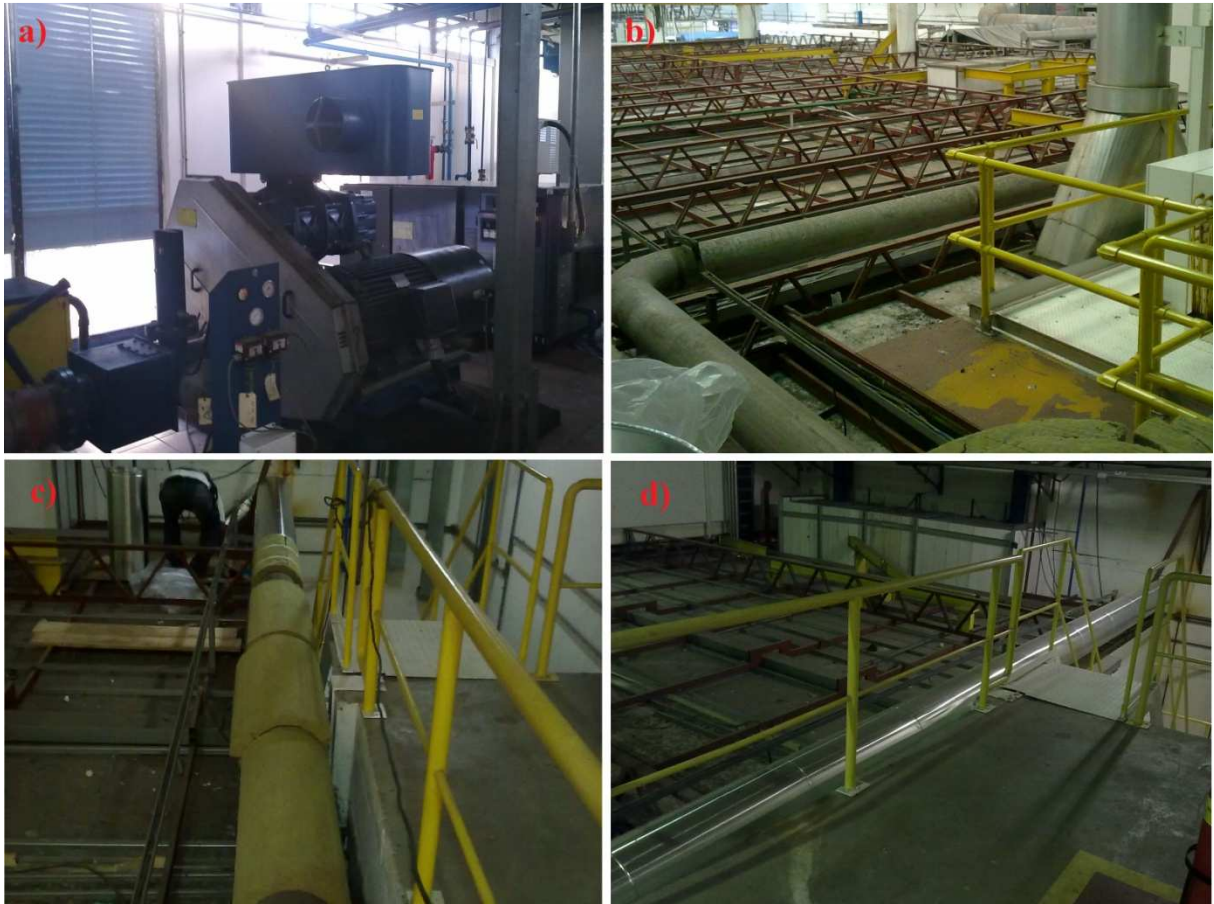
Figura 11: a) Compressor Aerzen; b) Tubulação sem isolamento; c) Instalação dos isolamentos; d) Tubulação isolada.
