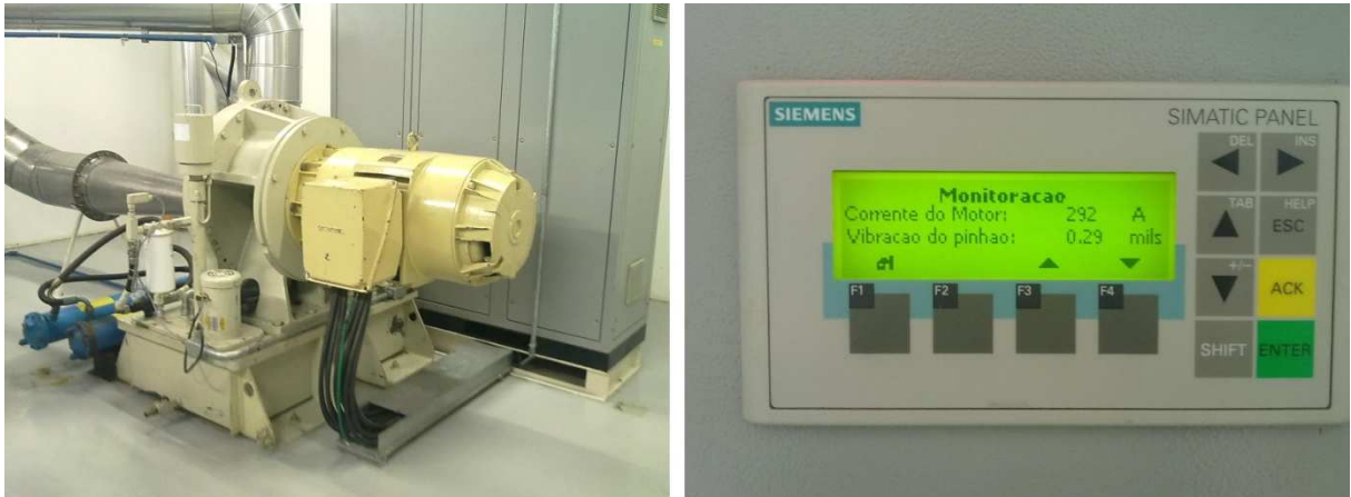
Figura 17: Compressor Centac da Ingersoll Rand à esquerda e painel seu de controle à direita.
