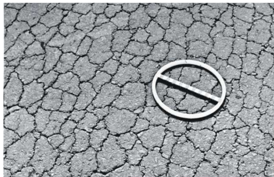
Figura I-3 - Foto de Trinca interligada J ou JE
