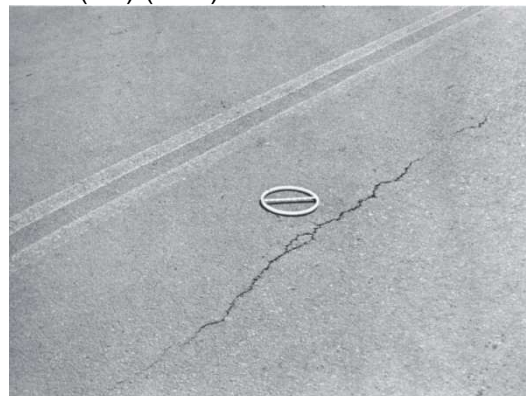
Figura I-7 - Foto de Trinca longitudinal (TLC) (TLL)
