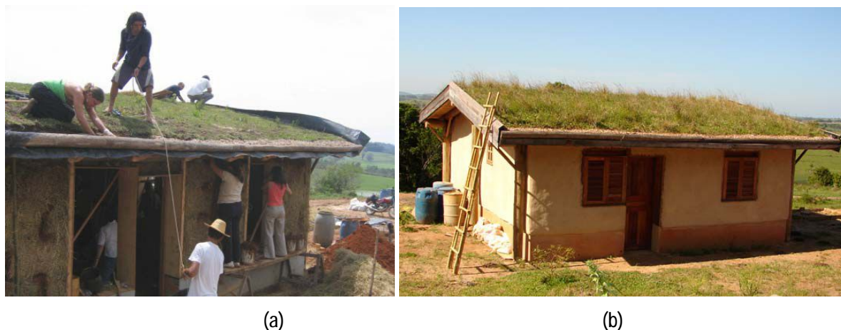
Figura 38: (a) construção de protótipo de fardos de palha, na Fazenda Capão Alto das Criúvas; (b) protótipo concluído. Fonte: 38a e 38b – Ingrid Pontes Barata Bohadana.
