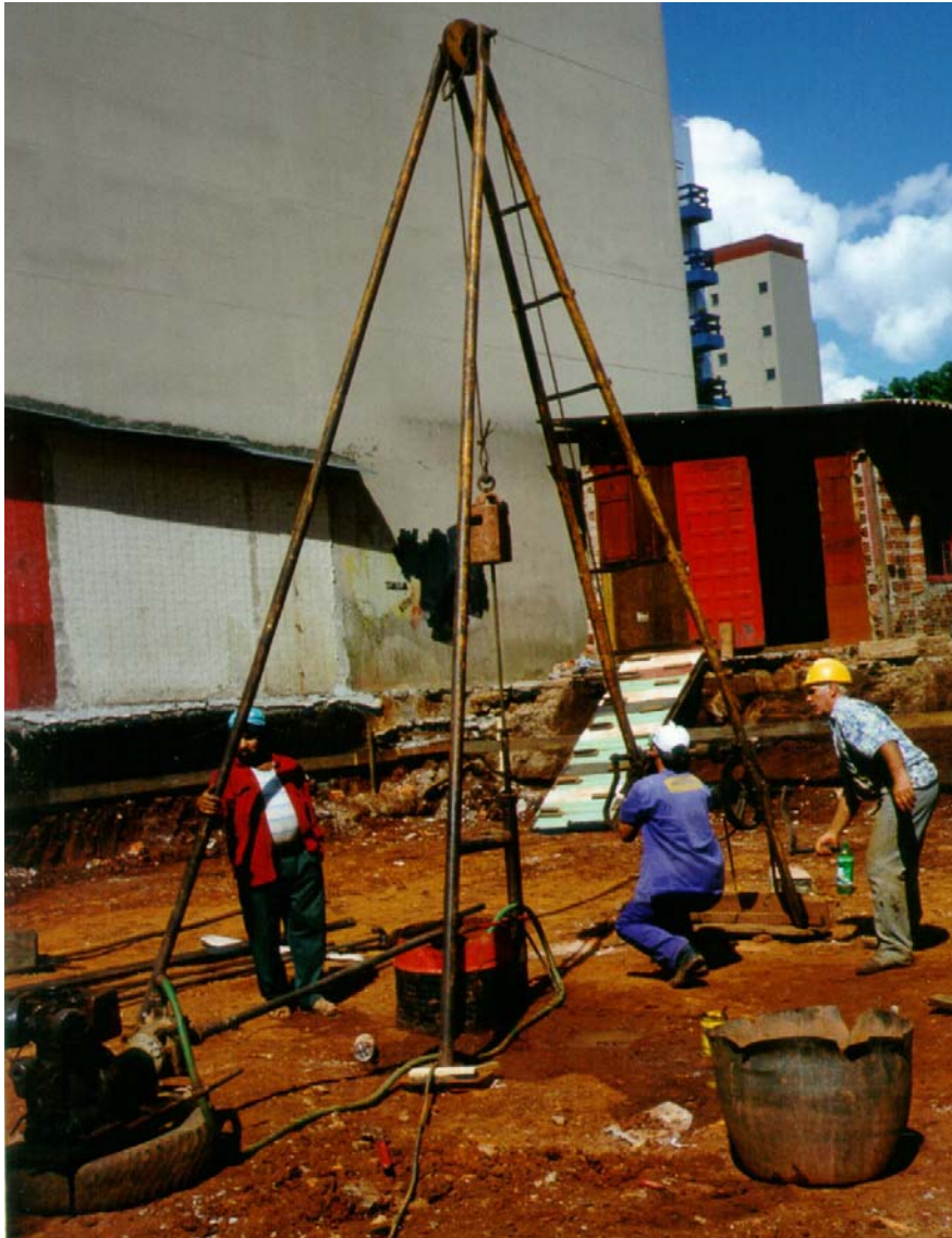
Figura 2.4 – Sondagem SPT executada na área de estudo pela empresa de sondagens e estaqueamentos – Multisolos (Passo Fundo/RS).
