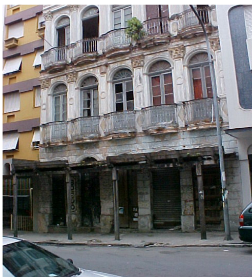
Imóvel Riachuelo 933 antes da restauração
