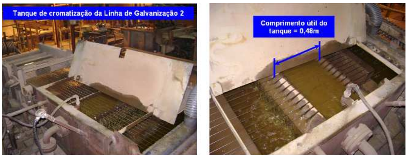
Figura 9. Tanque de solução cromatizante da Linha de Galvanização 2 da Gerdau Riograndense.
