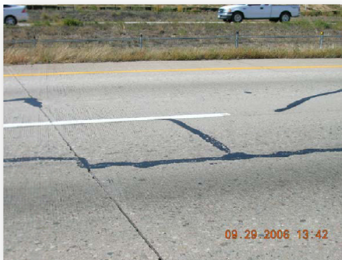
Figura 1.2: Fissuração por reflexão na superfície de um recapeamento de concreto [Colorado Department of Transportation]
