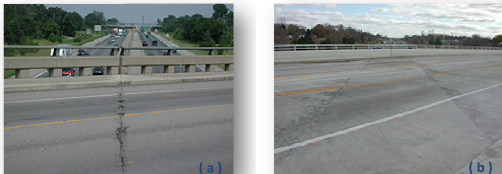
Figura 2.33: (a) Junta de ligação e (b) laje de ligação em ECC, localizada na Grove St., em Ypsilanti, MI, finalizada em Julho de 2005.
