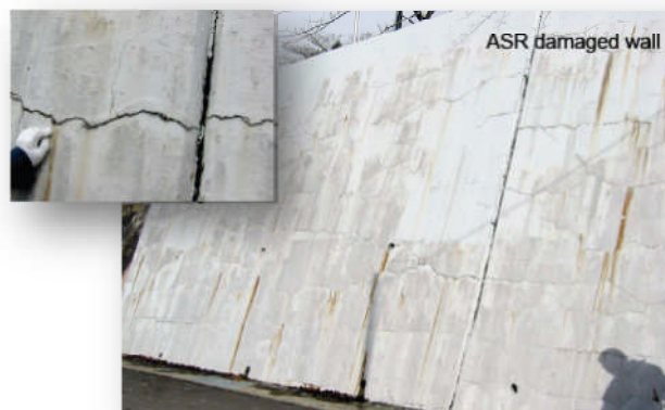
Figura 2.35: Muro de contenção na cidade de Gifu, Japão, danificado por reações álcali-agregado [fonte: Rokugo et al. , 2005]
