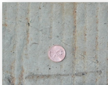
Figura 2.34: Fissura presente na laje de ligação. Abertura das fissuras se mantém entre 120 a 170 \mu\text{m} .
