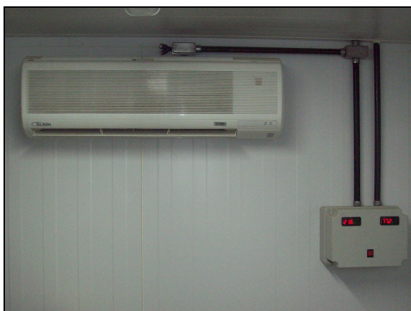
Figura 14: condicionador de ar e controle automático
