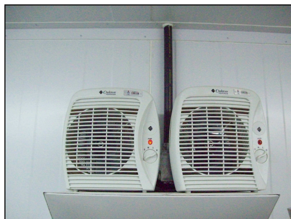
Figura 15: aparelhos de ventilação e aquecimento
