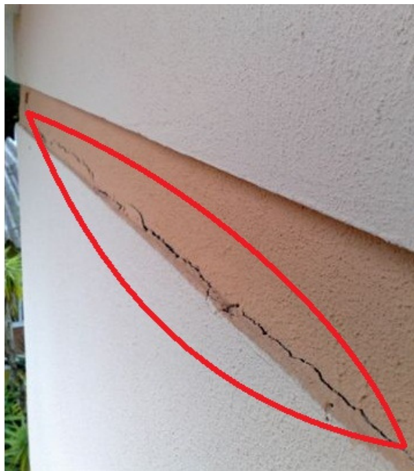
Figura 26 – fissura externa ocorrida devido a aparelho deslizante mal executado
