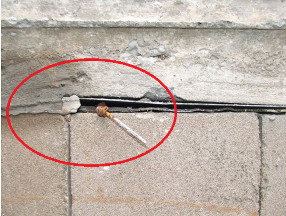
Figura 25 – aparelho deslizante executado incorretamente
