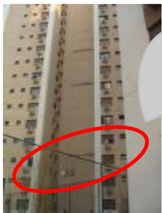
Figura 44: descolamento de revestimento na região de encunhamento em fachada (doada por construtora)
