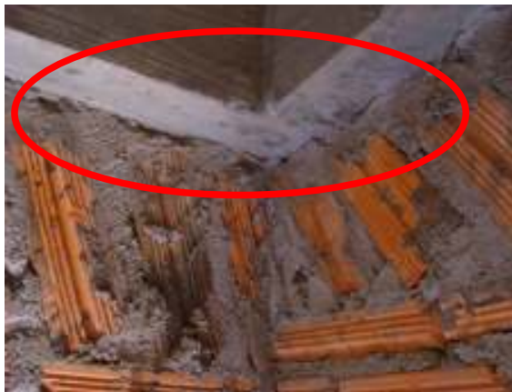
Figura 34: ausência de chapisco na estrutura
