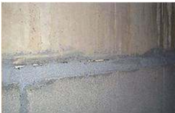
Figura 31: feixe de luz evidenciando a presença de vazios no encunhamento
