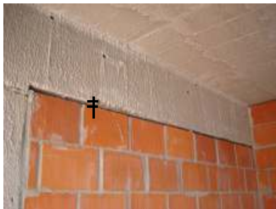
Figura 12: exemplo de abertura de encunhamento com aproximadamente 2 a 3 cm
