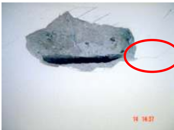
Figura 39: fissuras no revestimento derivadas da falta de encunhamento
