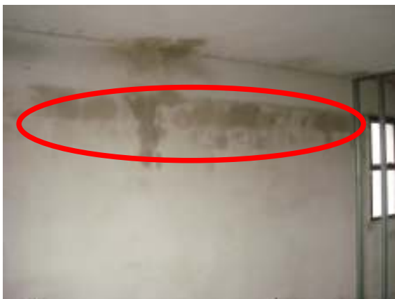
Figura 41: aparecimento de fissura no encunhamento com problemas de infiltração (dia de chuva)
