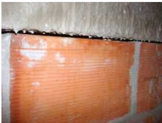
Figura 20: reduzido espaço para interação alvenaria com estrutura
