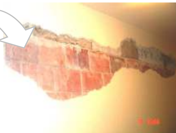
Figura 45: descolamento de revestimento na região do encunhamento em áreas internas (doada por construtora)
