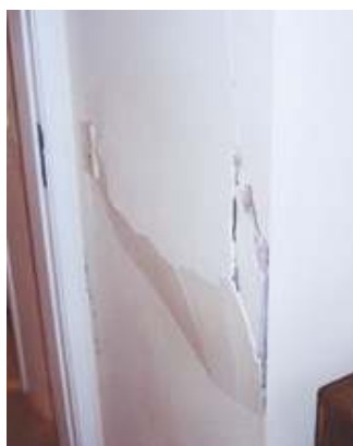
Figura 2: descolamento do revestimento (MEDEIROS, 2005a)
