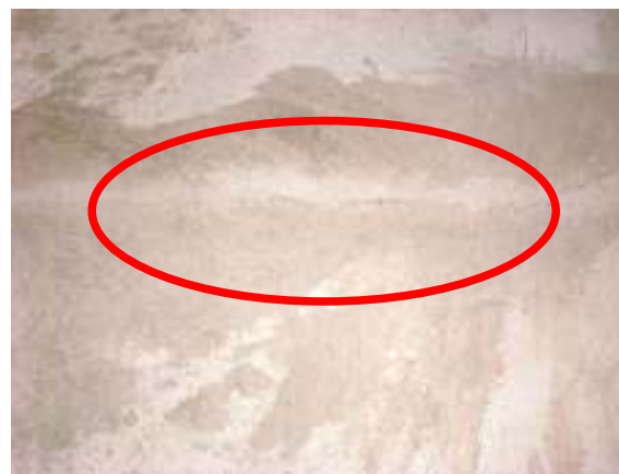
Figura 38: detalhe da fissura no emboço na região de encunhamento da parede
