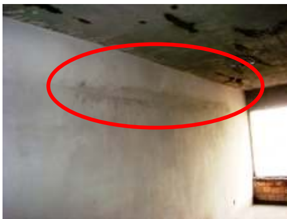
Figura 37: aparecimento de fissura no emboço na região de encunhamento da parede
