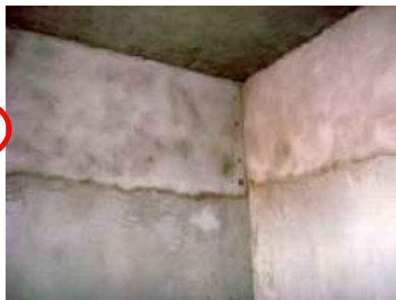
Figura 40: reparo de fissuras no revestimento derivadas da falta de encunhamento
