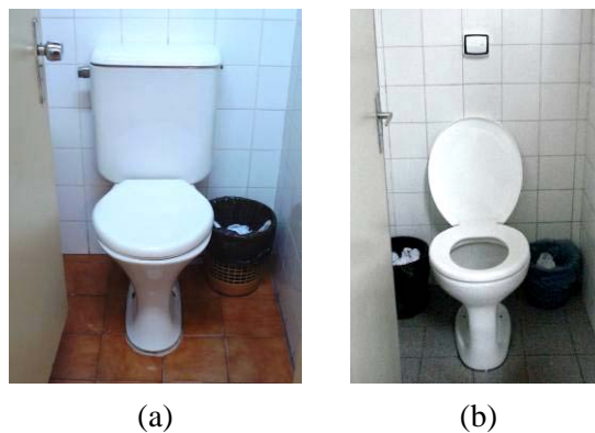
Figura 29: tipos de bacias sanitárias na edificação: com caixa acoplada (a), bacias antigas com válvulas de descarga (b)
