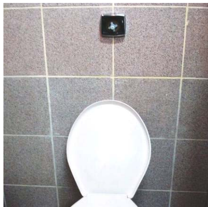
Figura 22: furto de capa de válvula de descarga
