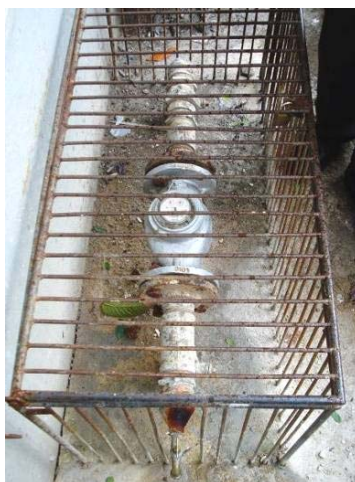
Figura 23: hidrômetro da Câmara Municipal de Porto Alegre
