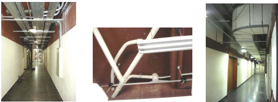
Figura 15: instalações aparentes nas dependências internas da edificação da CMPA
