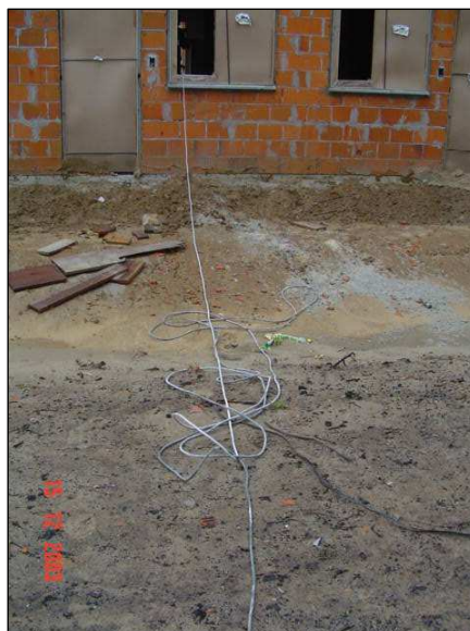
Figura 13: exemplo de má conduta no item Instalações Elétricas. Fonte: COSTA, et al., 2003.
