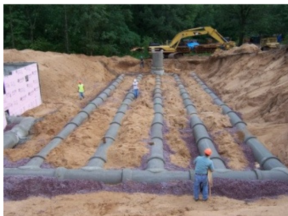
Figura1: EarthTubes sendo instalados no Aldo Leopold Legacy Center em Toronto, Canadá (fonte: http://www.treehugger.com/files/2008/04/earth-tubes.php , visita em 20/09/2010)
