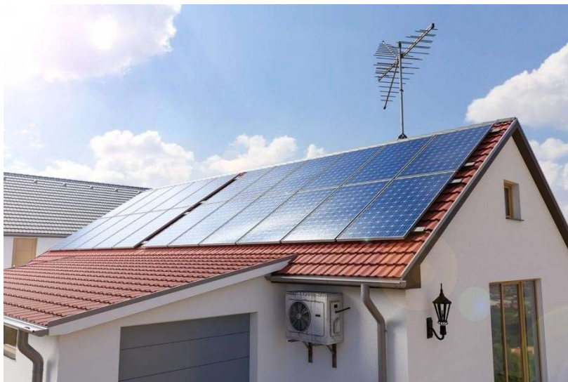
Figura 21: Placas de energia solar
