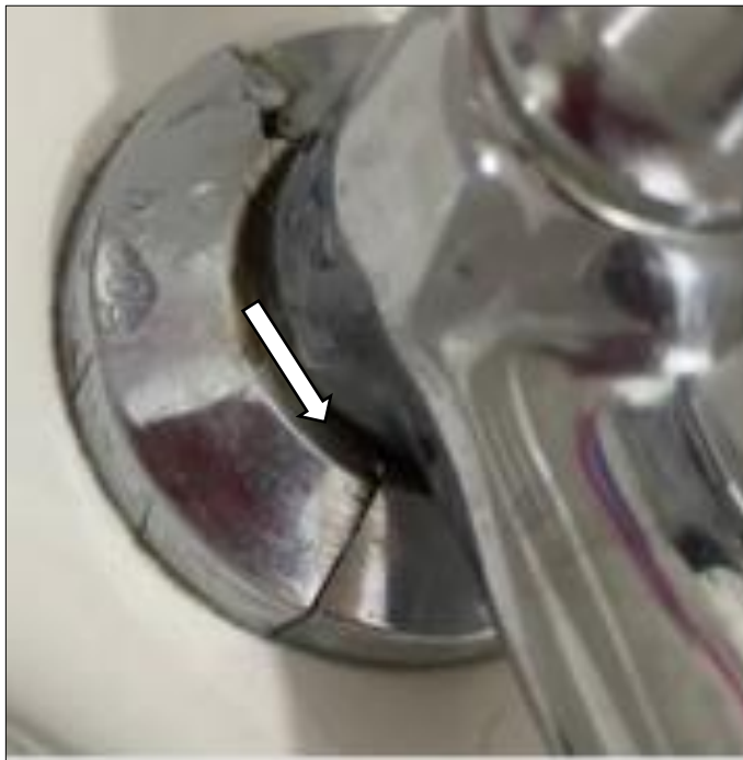
Figura 26 - Imagem de um metal com a canopla danificada.
