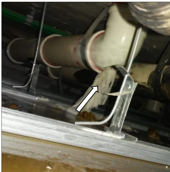
Figura 12 – Ocorrência de rompimento da curva existente no ramal de esgoto. As setas indicam a localização do vazamento e o acúmulo de material no forro.
