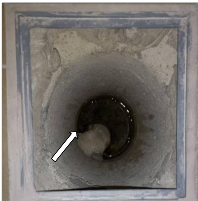
Figura 31 - Ralo entregue com fecho hídrico com sifão inadequado.
