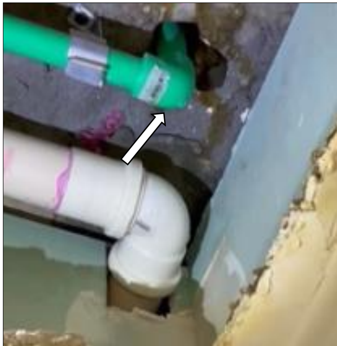
Figura 9 – Vazamento em instalações de água causadas pela falha no processo de soldagem. Indicação presente na figura aponta o vazamento.
