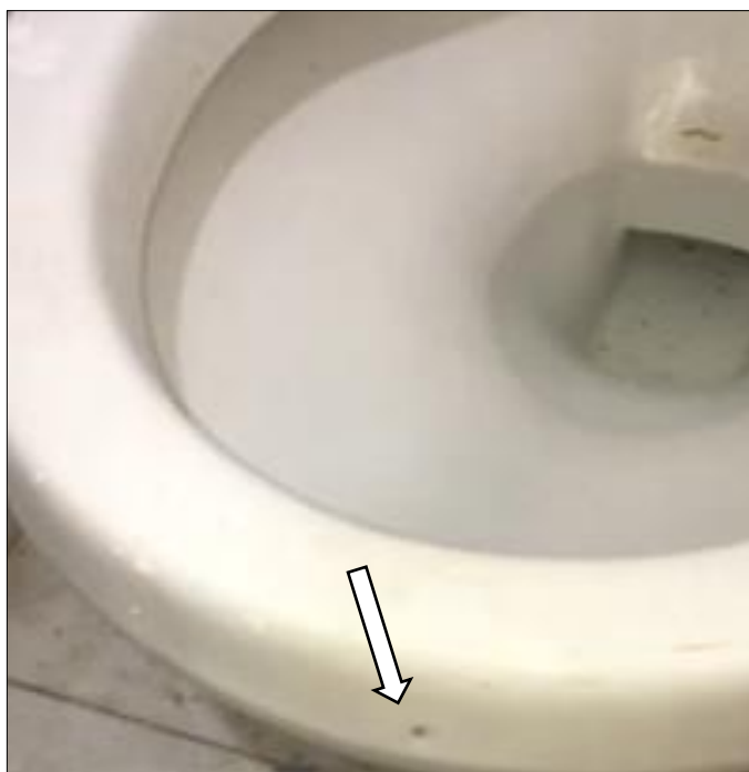
Figura 32 - Falha visual na louça entregue.
