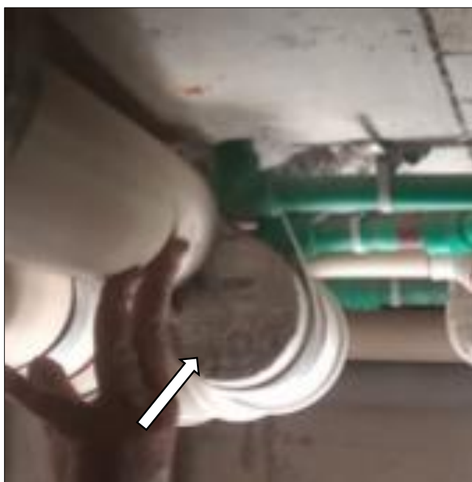
Figura 18 – Entupimento de ramal de descarga decorrente do acúmulo de argamassas, como indica a seta. DN = 100 mm.
