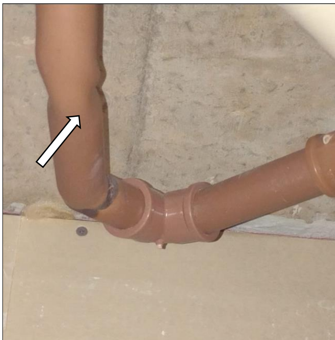
Figura 20 – Estreitamento de uma tubulação de um empreendimento entregue.
