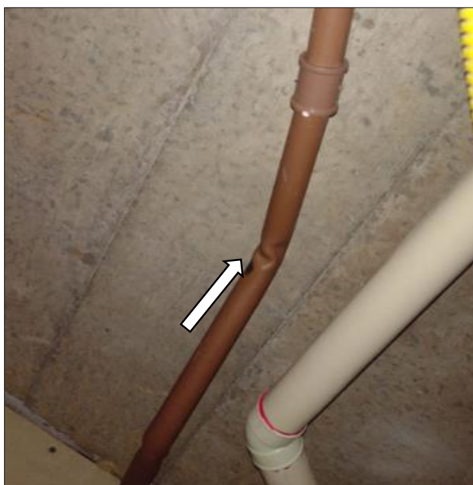
Figura 19 – Estreitamento de uma tubulação de dreno de ar-condicionado de um empreendimento entregue. Tubulação de 25 milímetro de diâmetro nominal.
