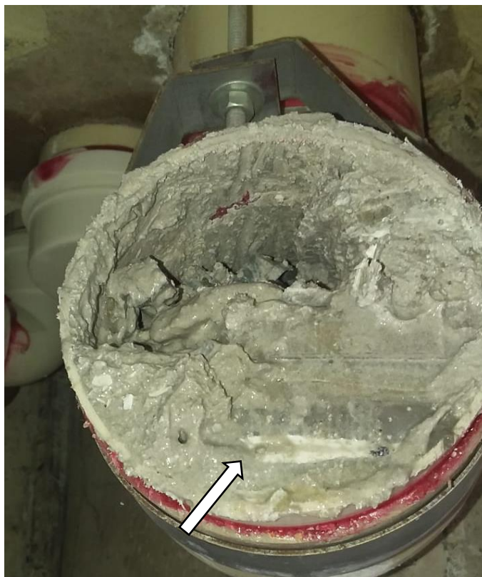
Figura 17 – Entupimento de ramal de descarga decorrente do acúmulo de argamassas, como aponta a seta. DN = 100 mm.
