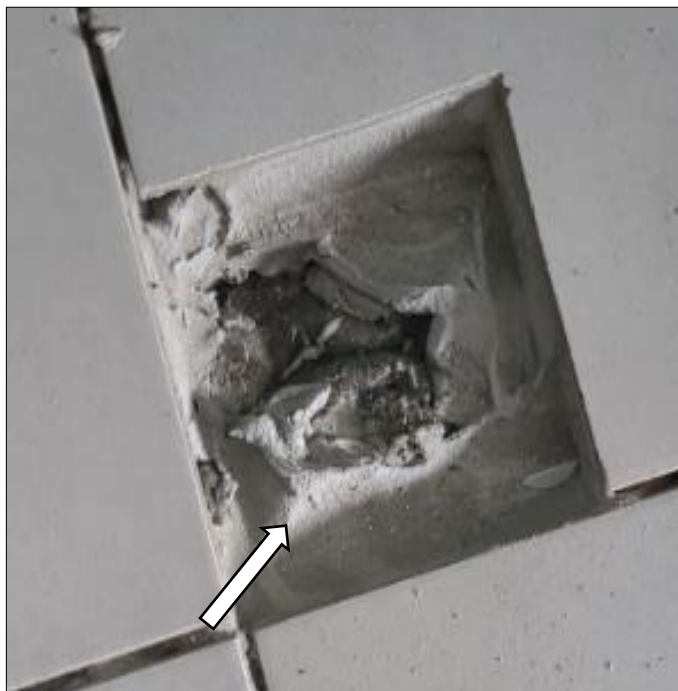
Figura 48 - Acúmulo de argamassa de assentamento cerâmico na região do ralo.
