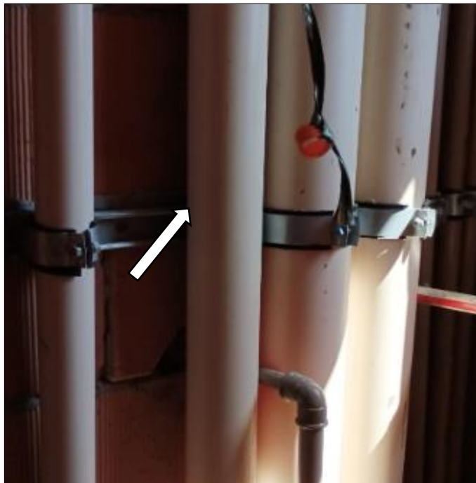
Figura 41 - Falta de fixação da tubulação indicada. DN = 100 mm.
