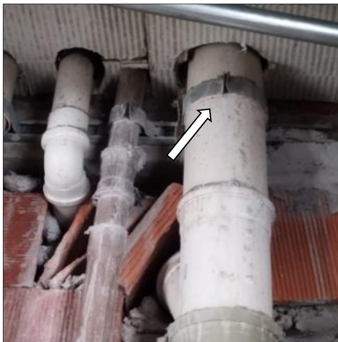
Figura 40 - Falta da banca acústica entre abraçadeira e tubulação. DN = 100 mm.
