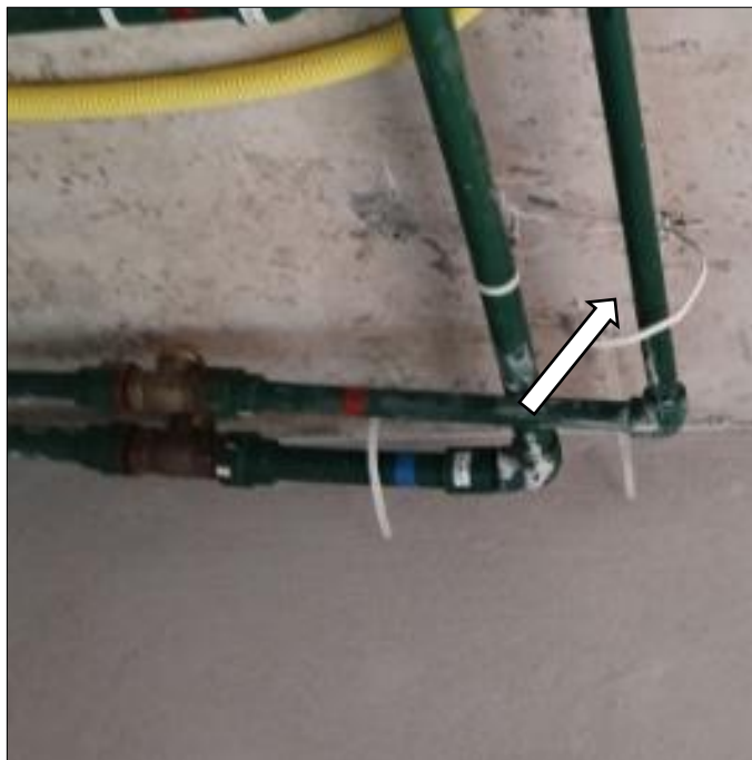
Figura 39 - Fixação de tubulações de água soltas, como apontado. DN = 32 mm.
