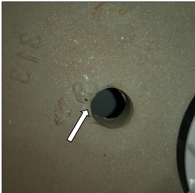
Figura 33 - Falha de terminalidade do material, impedindo a correta vedação.
