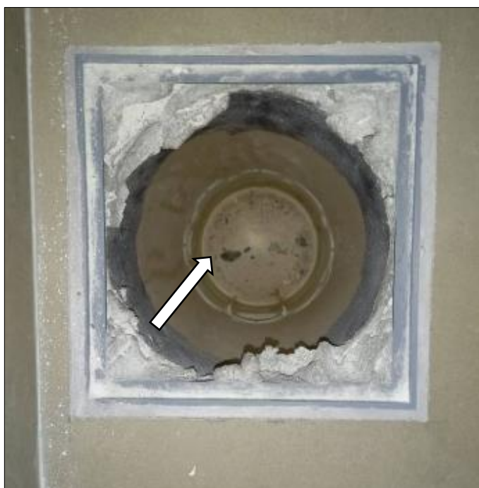
Figura 30 - Ralo entregue sem fecho hídrico e sem sifão.
