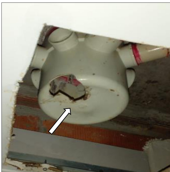
Figura 44 - Ralo danificado, como indica a seta.
