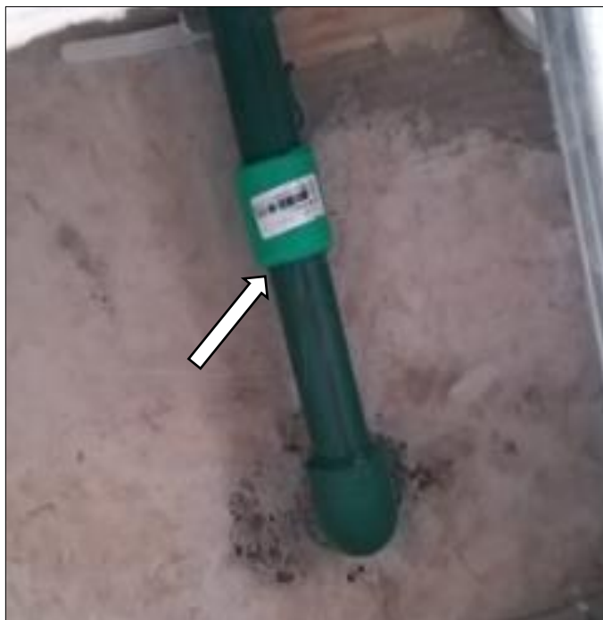
Figura 11 – Vazamento ocorrido pela utilização de materiais de fornecedores diferentes. Os diferentes tons de verde apontados pela seta indicam que são fornecedores distintos.
