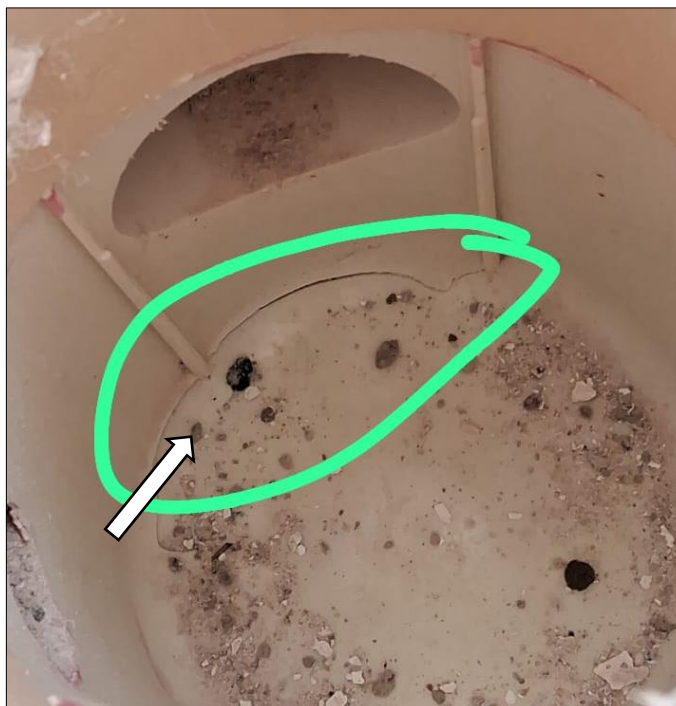
Figura 49 - Ralo (caixa sifonada) danificado no momento da limpeza.
