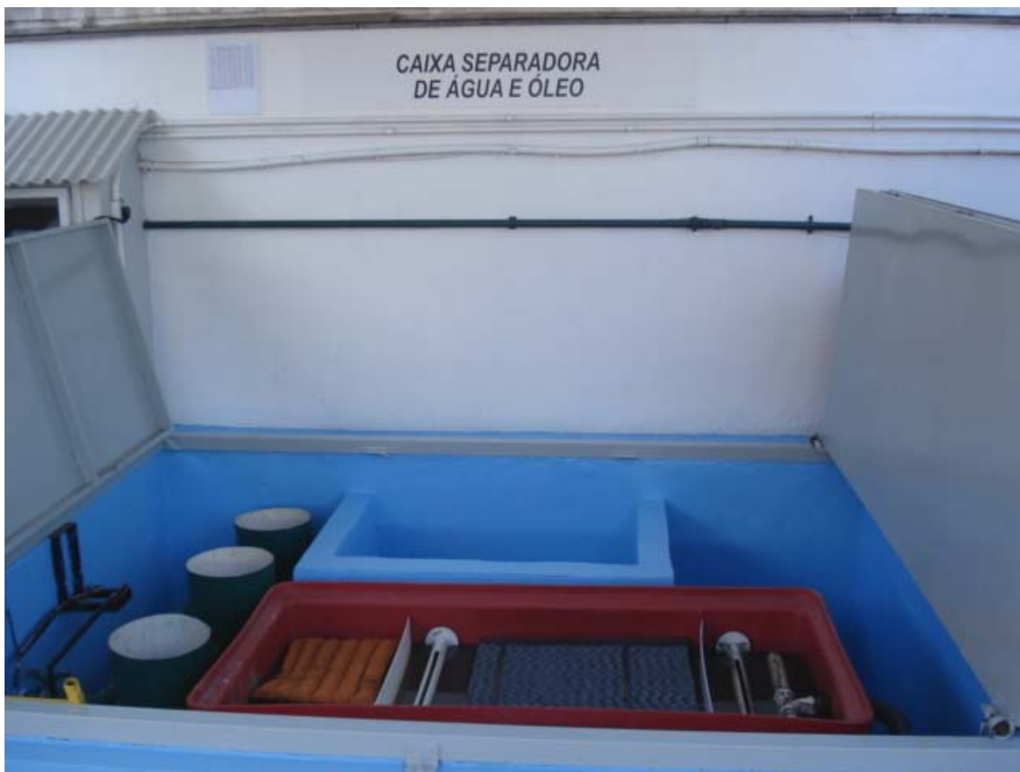
Figura 4: foto da caixa separadora água-óleo instalada na empresa Fonte: arquivo de imagens da empresa
