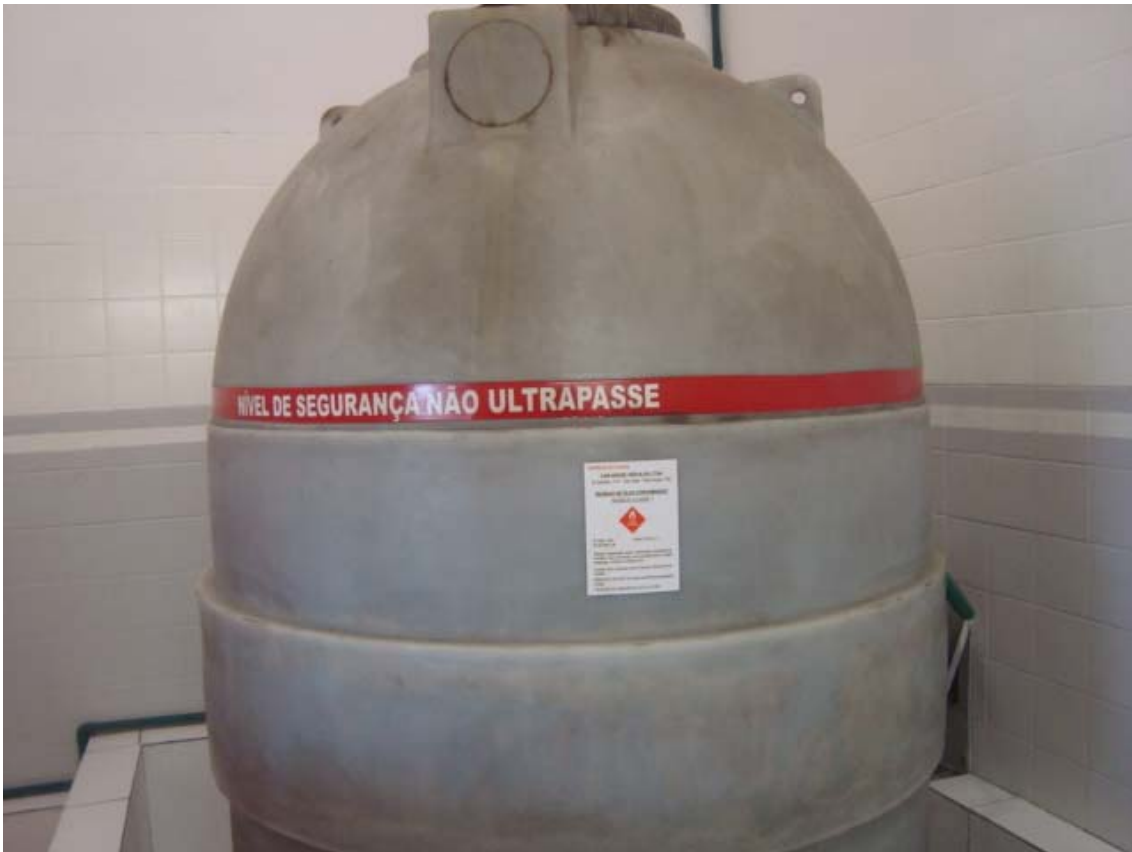
Figura 12: foto do reservatório de óleo residual instalado na CarHouse matriz Fonte: arquivo de imagens da empresa
