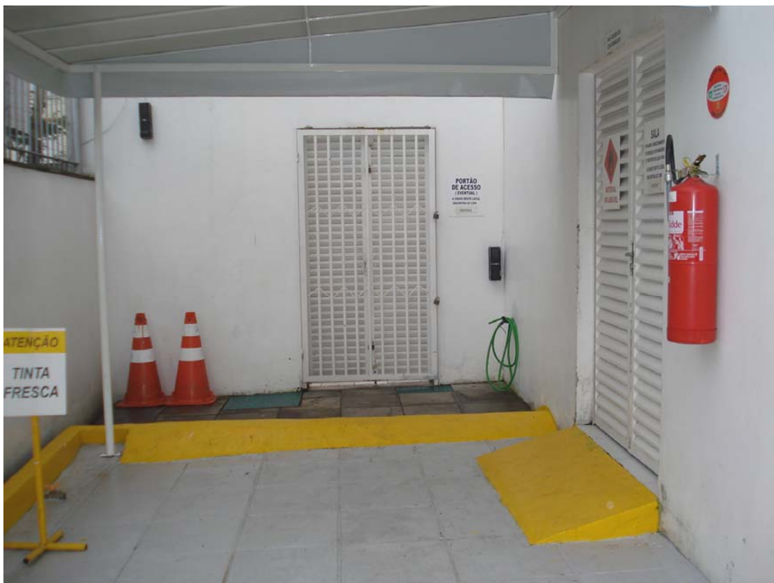
Figura 10: foto externa da sala de resíduos perigosos Fonte: arquivo de imagens da empresa
