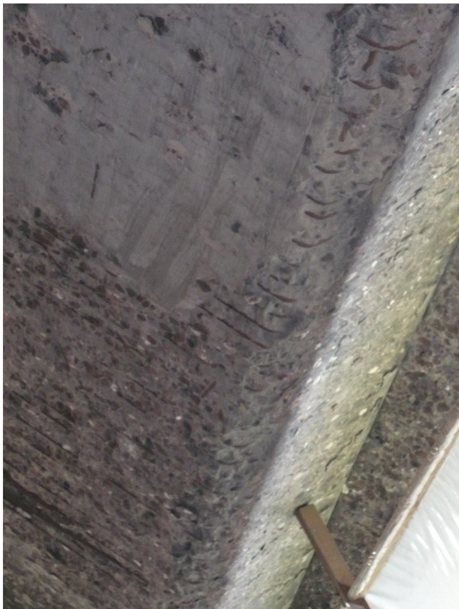
Figura 67: exemplo do estado de deterioração da estrutura do viaduto. Foto de André Furtado.
