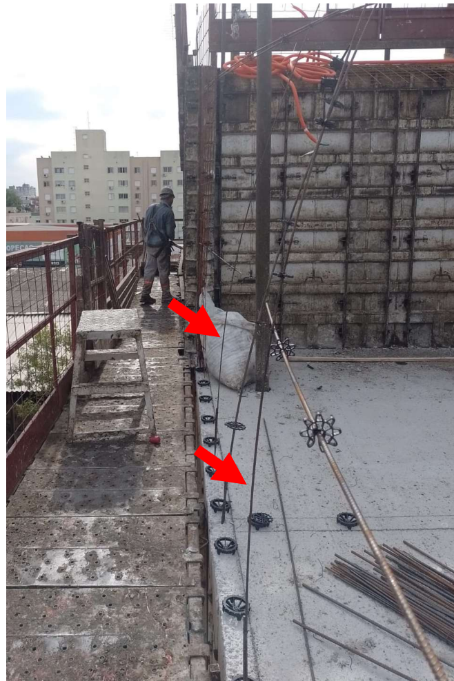
Figura 20: Barras de reforços de janela prolongadas até a laje (Fonte: o autor).
