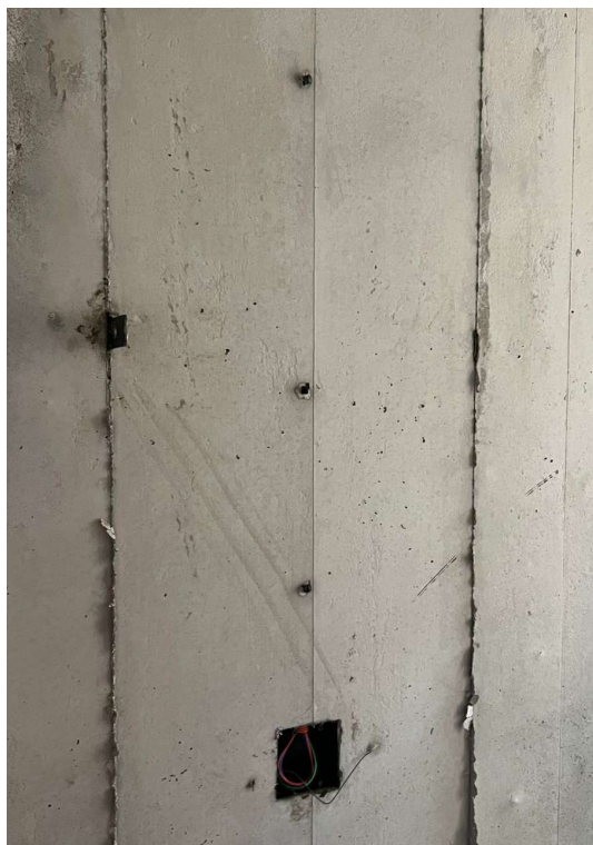
Figura 44: Pontas dos espaçadores expostas na pós-concretagem (Fonte: o autor).
