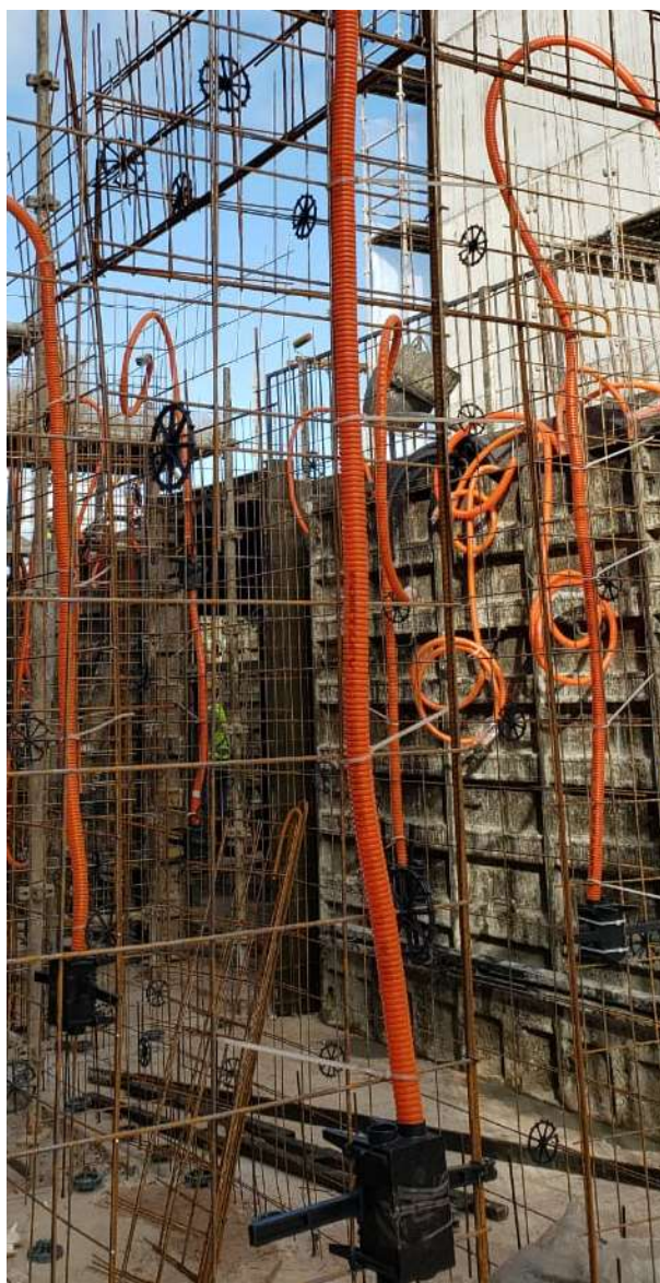
Figura 17: Tubulações elétricas embutidas presas na armação da parede (Fonte: o autor).
