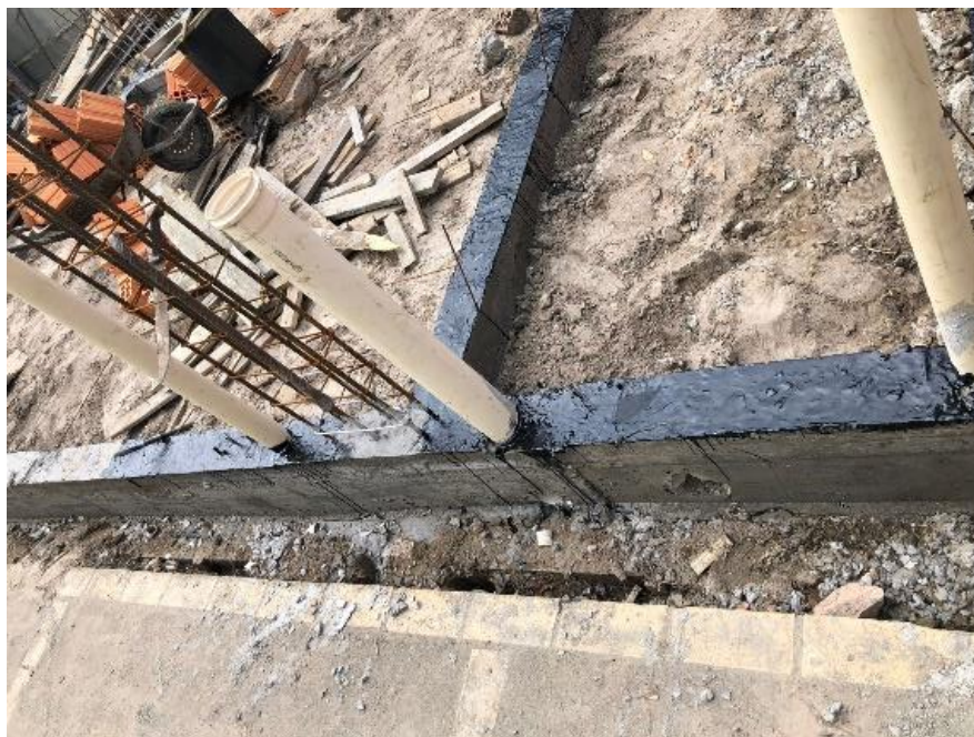
Figura 12 - vigas baldrames com impermeabilização incompleta
