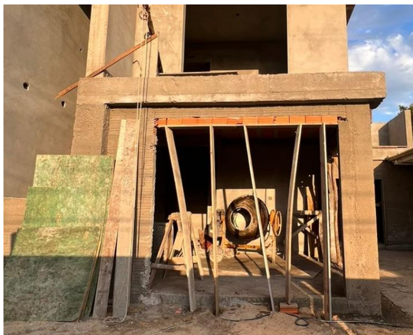
Figura 14 - Retrabalho para correção de cotas em abertura com a remoção da verga
