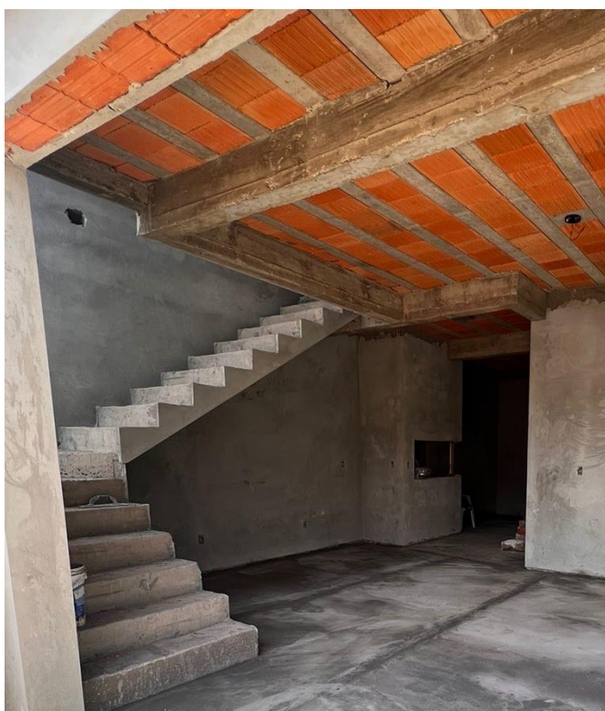
Figura 21 - viga estrutural com redução de seção
