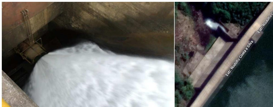
Figura 23 – Válvula dispersora Rowell DN600 mm e Imagem de satélite do vertedouro da barragem.
