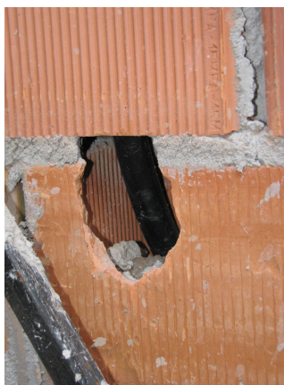
Figura 37: instalação do eletroduto através dos vazados dos blocos cerâmicos na obra B
