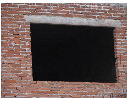
Figura 31: verga de concreto pré moldada em vão de janela na obra A1
