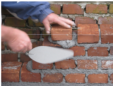
Figura 27: assentamento de unidades com uso de colher de pedreiro na obra A2
