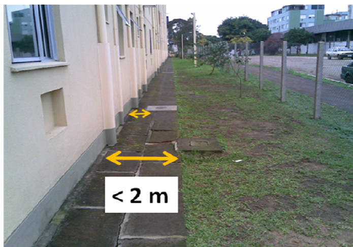
Figura 8: distância entre a caixa de inspeção e o tubo de queda
