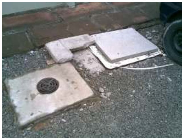
Figura 9: caixa de inspeção quebrada no estacionamento
