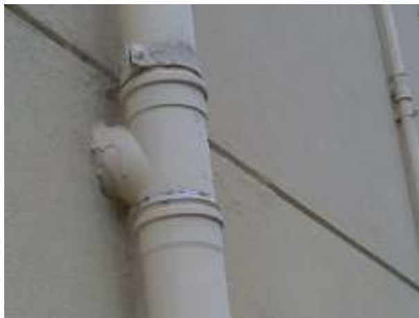
Figura 4: tubos fixados na fachada por braçadeiras metálicas
