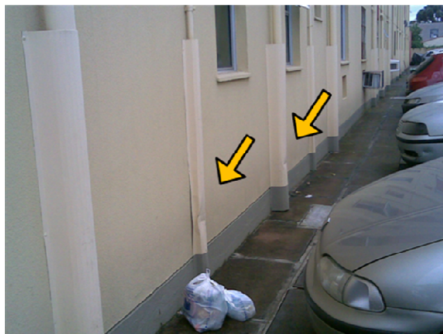
Figura 7: proteções das tubulações amassadas
