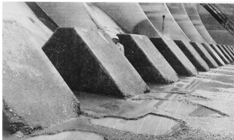
Figura 16: efeito da cavitação junto aos blocos anexos na laje de fundo do dissipador de energia da Barragem de Bonneville (ELEVATORSKI, 1959, p. 100)
