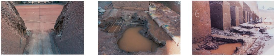
Figura 17: danos causados pela cavitação na laje de fundo do dissipador de energia da Usina Hidrelétrica Porto Colômbia (CARVALHO, 2009)
