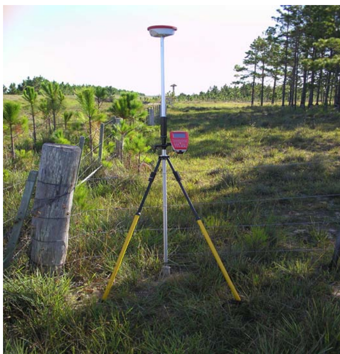
Fig. 14 – Materialização de marco tipo M na divisa da faixa de domínio da Rodovia BR 101–Sul e coleta das coordenadas do ponto denominado de DN0 – M – 0002.
