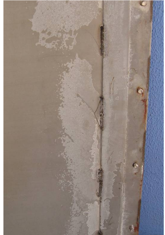
Figura 5 – Vista posterior da chapa do defletor. Observa-se ainda o reforço instalado.
