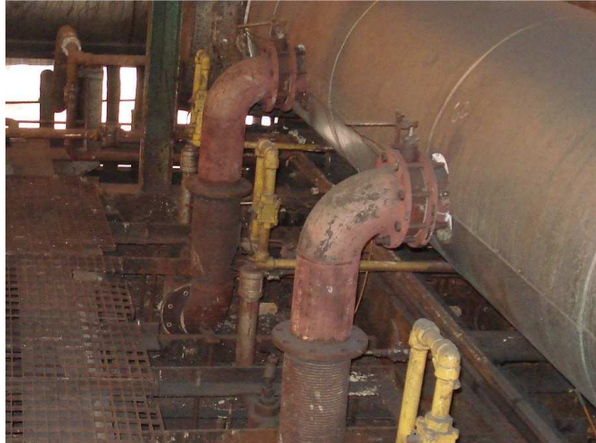
Figura 4.1 – Dutos de distribuição de ar de combustão não isolados.
