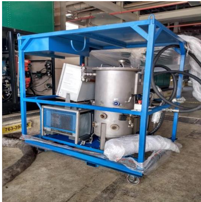
Figura 10 – Termo vácuo instalada para desidratação do óleo.
