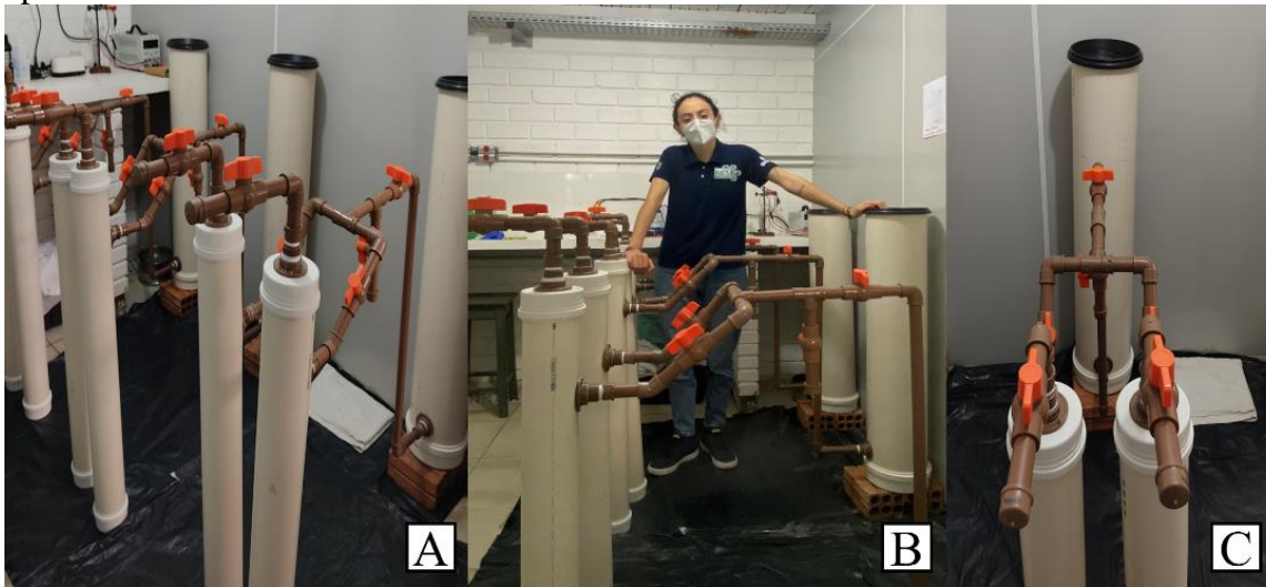
Figura 5.1. Sistema de tratamento completo instalado, a) vista geral, b) vista lateral c) vista superior do sistema.
