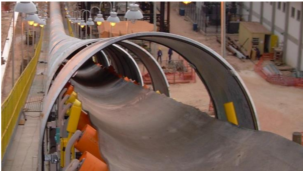
Figura 3.9. Transportador de Correia Executado (fonte Tecnologia em Movimentação SA/2006)
