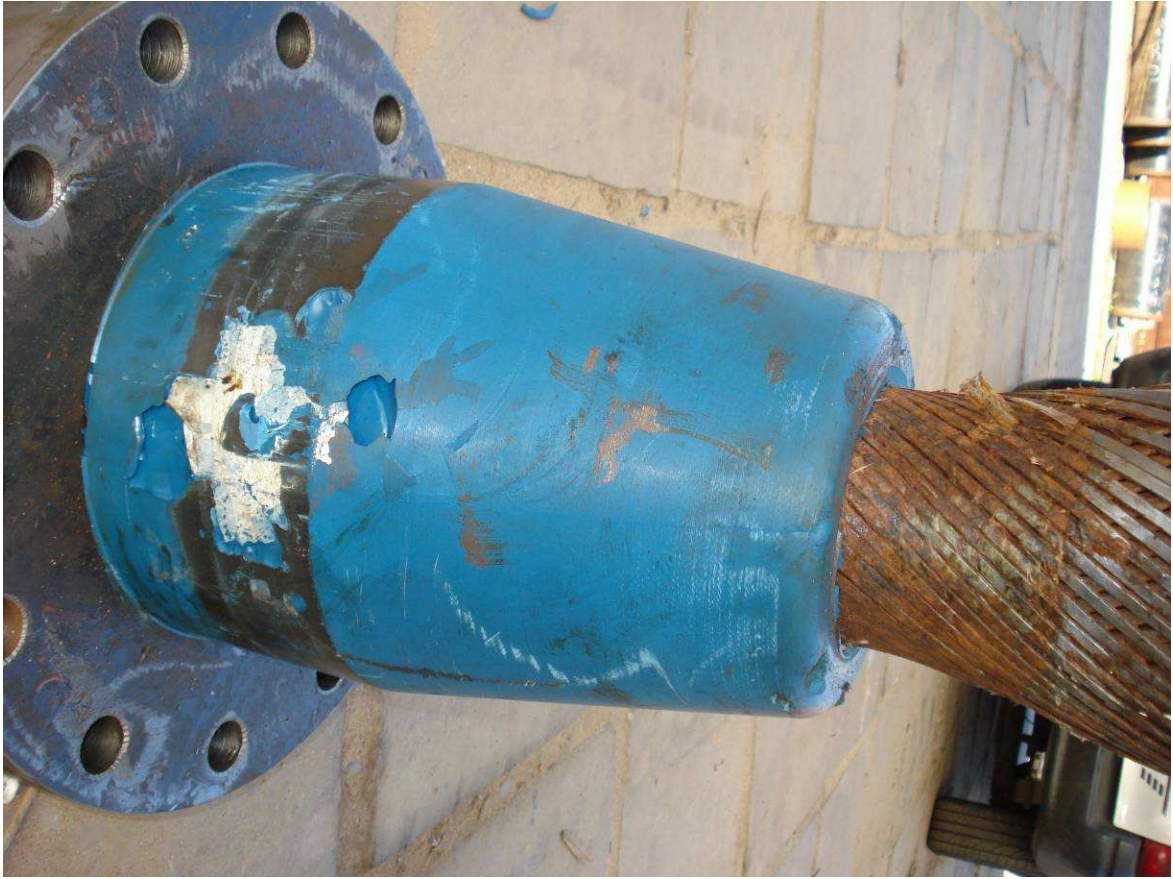
Figura 5-15. Detalhe da resina do conector 2 após a remoção da capa.
