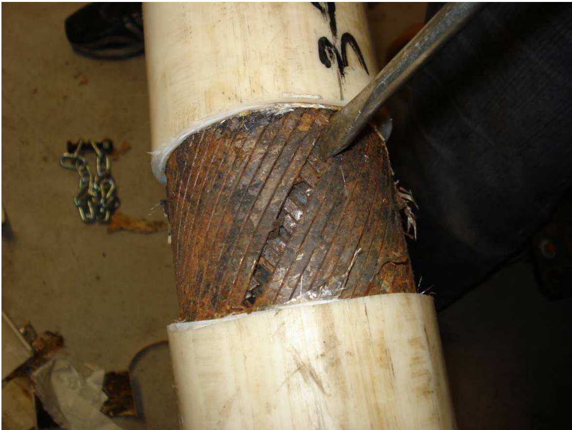
Figura 6-3. Localização de tendões da armadura interna rompidos.
