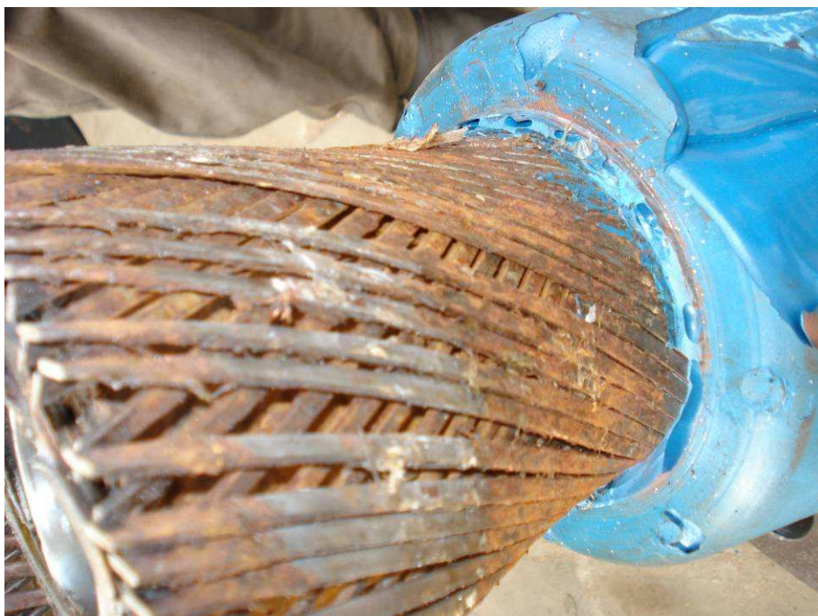
Figura 6-5. Detalhe de tendão rompido próximo ao conector 1.
