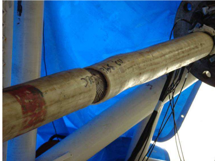
Figura 5-13 Detalhe da região deformada na camada de polímero externa.
