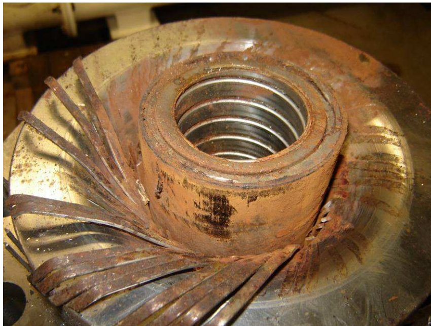
Figura 5-5. Detalhe dos tendões rompidos junto ao conector de aperto.
