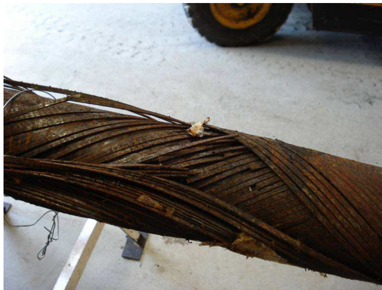
Figura 5-14. Detalhe dos tendões rompidos após a remoção da camada externa.
