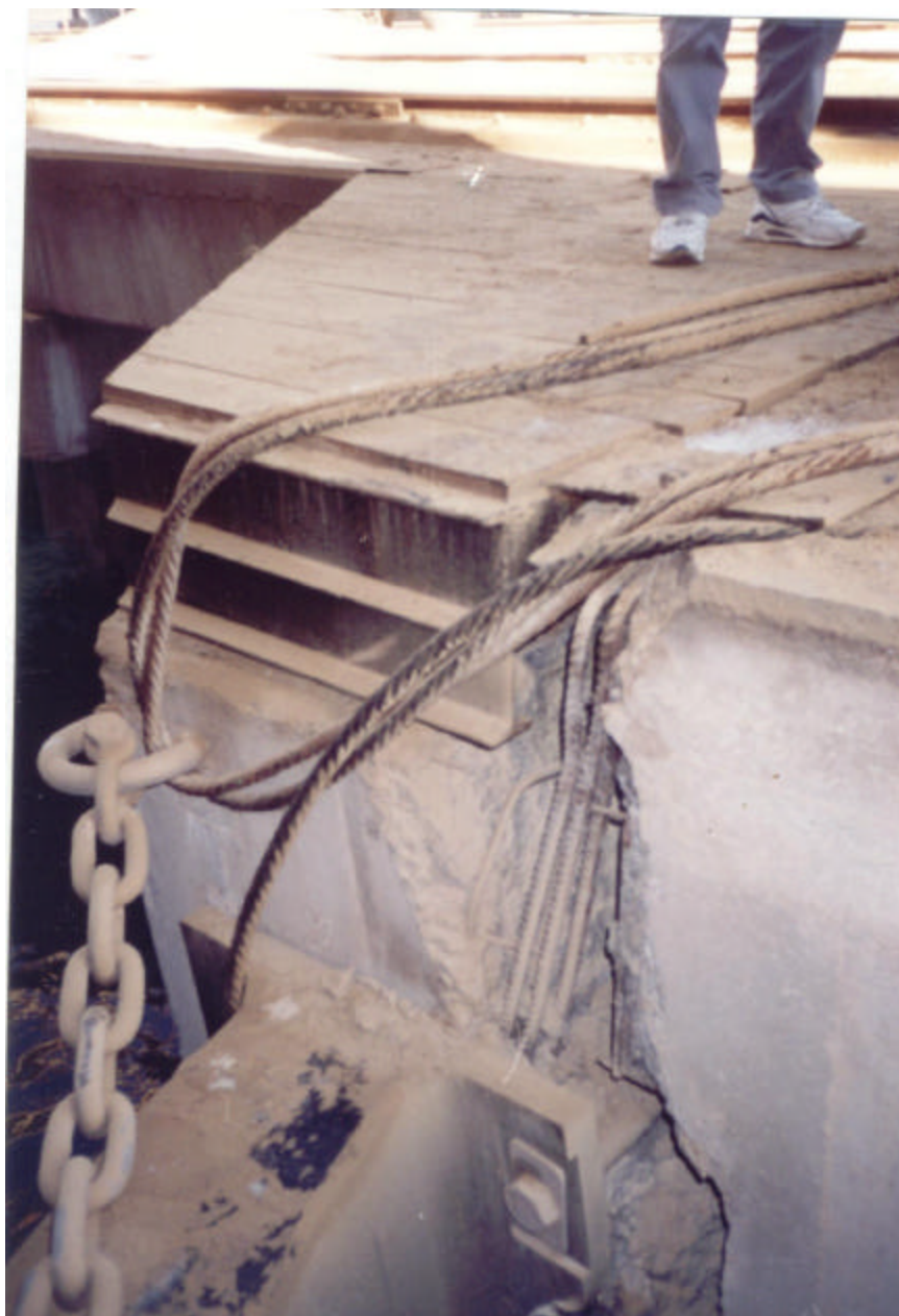
Figura 9.4-7: Fotografia da fissura encontrada in loco.
