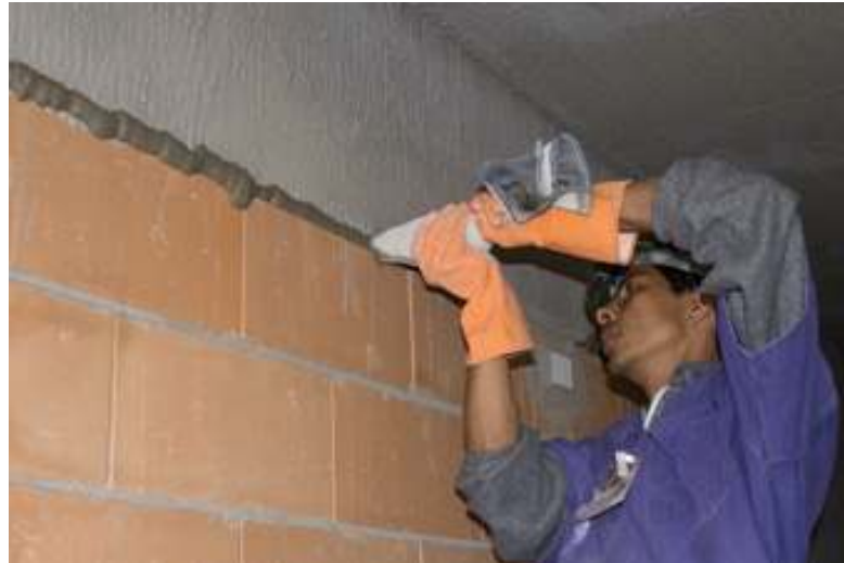
Figura 6: execução do encunhamento rígido, com auxílio de uma bisnaga (FRANCO, 2005 apud DALDON, 2008, p. 28)
