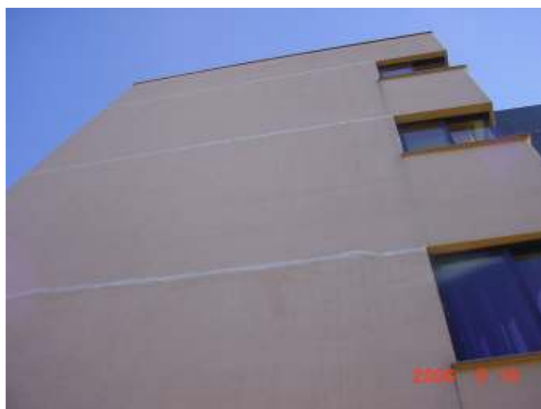
Figura 8: fissuras reparadas na área do encunhamento (CONSOLI, 2006, p. 140)
