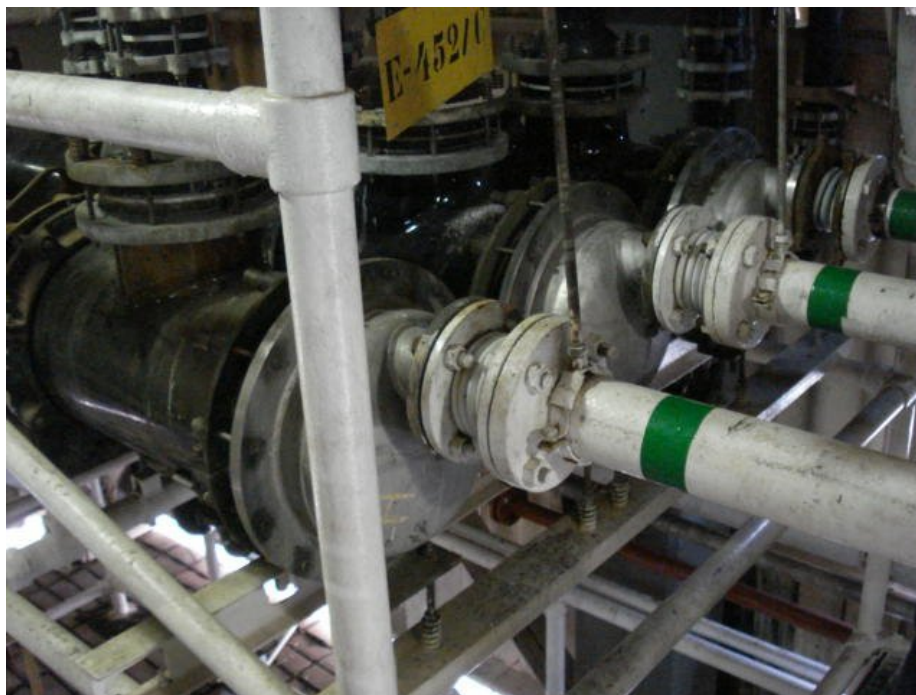
Figura 3.1: Trocadores de calor em paralelo no local de funcionamento
