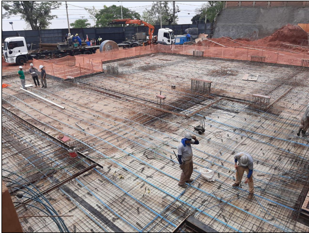
Figura 12 – Colocação dos cabos de aço para protensão na laje do pavimento térreo.
