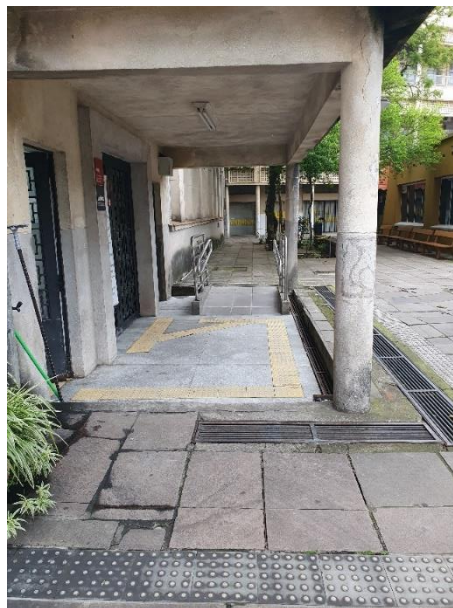
Figura 49 – Patamar superior dos degraus isolados no acesso da PRAE
