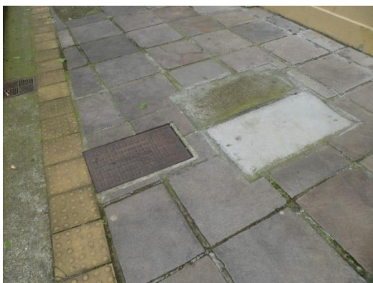
Figura 87 – Caixas de inspeção da rota 5
