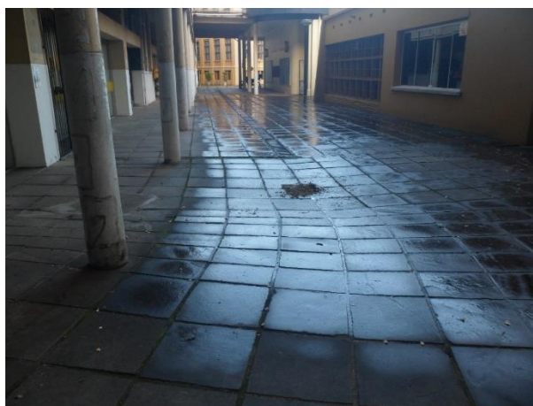
Figura 67 – Piso irregular e grelhas instaladas longitudinalmente
