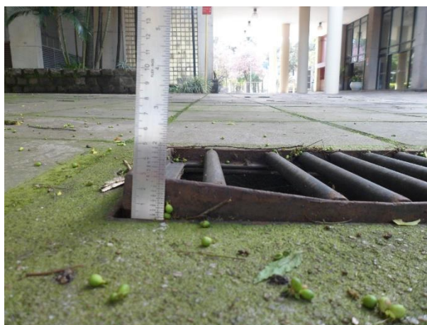
Figura 101 – Grelha com superfície desnivelada
