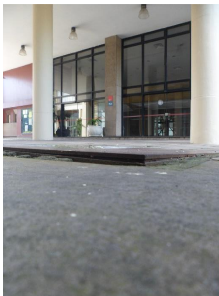
Figura 102 – Caixa de inspeção com superfície desnivelada
