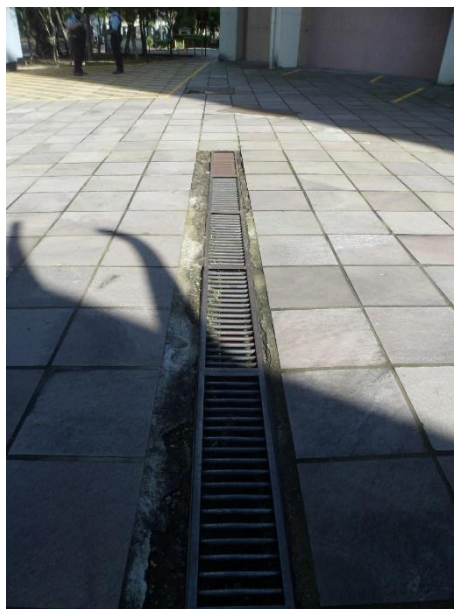
Figura 103 – Grelha com acabamento irregular
