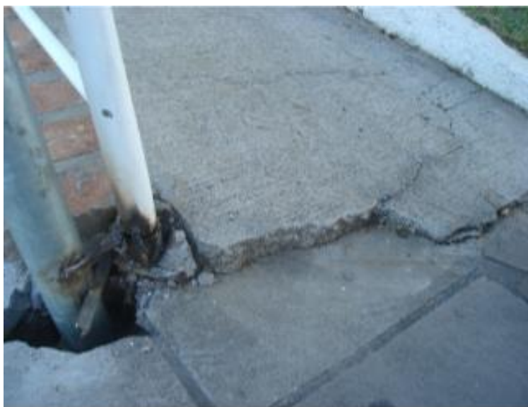
Figura 108 – Má conservação do encontro entre a rampa e o piso da circulação
