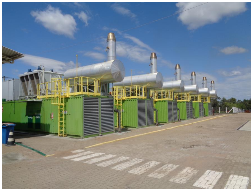
Figura 19. Aproveitamento energético dos gases gerados no aterro sanitário
