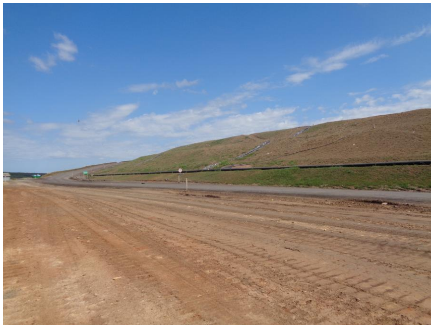
Figura 18. Área encerrada com cobertura, drenagem de gases e pluvial
