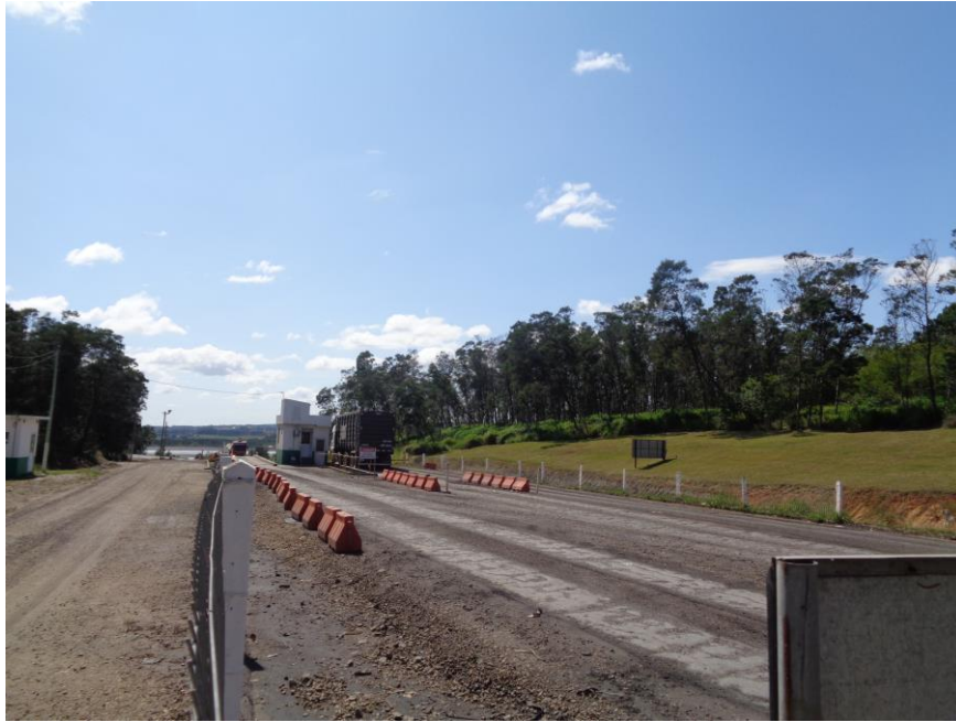
Figura 15. Balança para pesagem dos resíduos e guarita de controle
