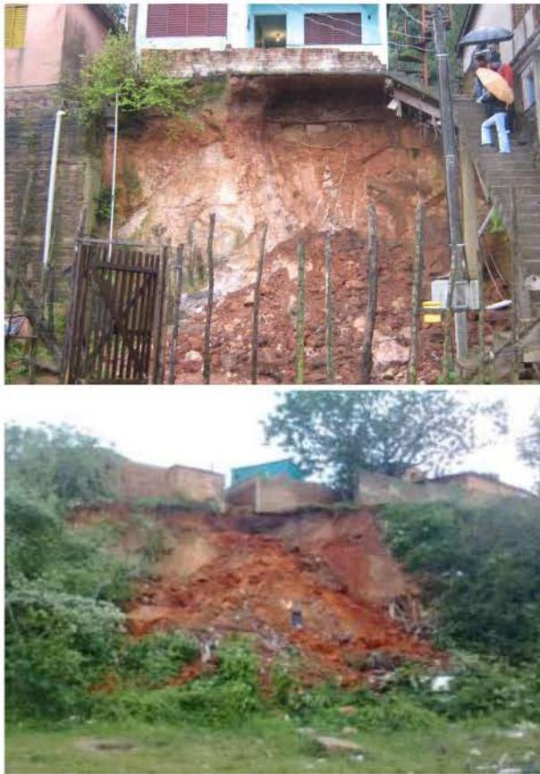
Fig. 6 - Escorregamentos planares deflagrados pela ação antrópica: (a) Talude de corte com inclinação excessiva na Rua Dallas em 2007. O substrato é constituído por solo saprolítico do granito Santana, com cerca de 30 cm de espessura; (b) Encosta natural na Rua São Guilherme em 2012, onde esgoto e entulhos eram lançados diretamente na encosta. Neste local, o solo residual arenoso do granito Ponta Grossa possui em torno de 1 m de espessura. Fonte: imagens cedidas pelo PAR (2013).
