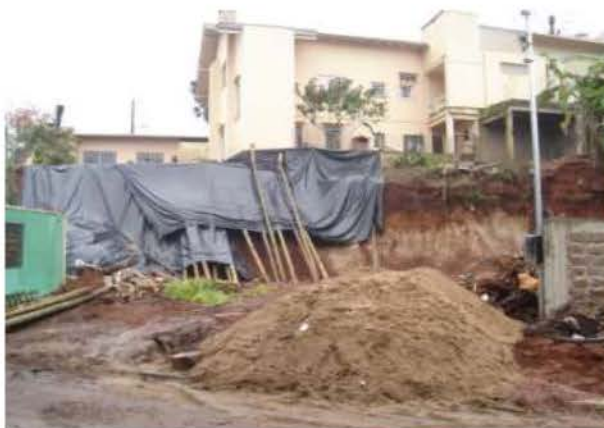
Fig. 7 - Escorregamento planar em talude de corte com geometria inadequada e sem cobertura vegetal em área de ocupação regular. Rua Prof. Antônio José Remião em 2008. Fonte: imagem cedida pelo PAR (2013).
