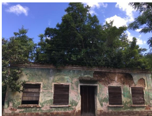
Figura 14- Imóvel em ruínas na Área de Entorno de Triunfo de propriedade da Prefeitura Municipal.
