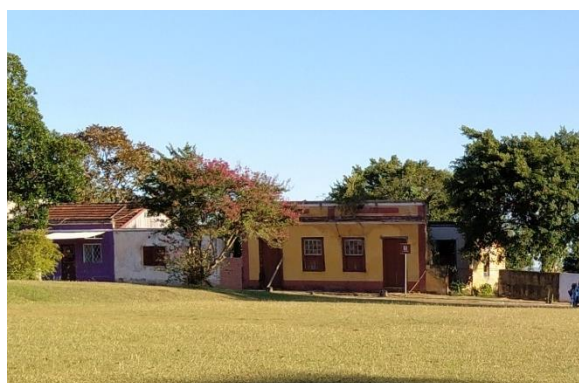
Figura 16 - Duas casas em ruínas no entorno da praça.
